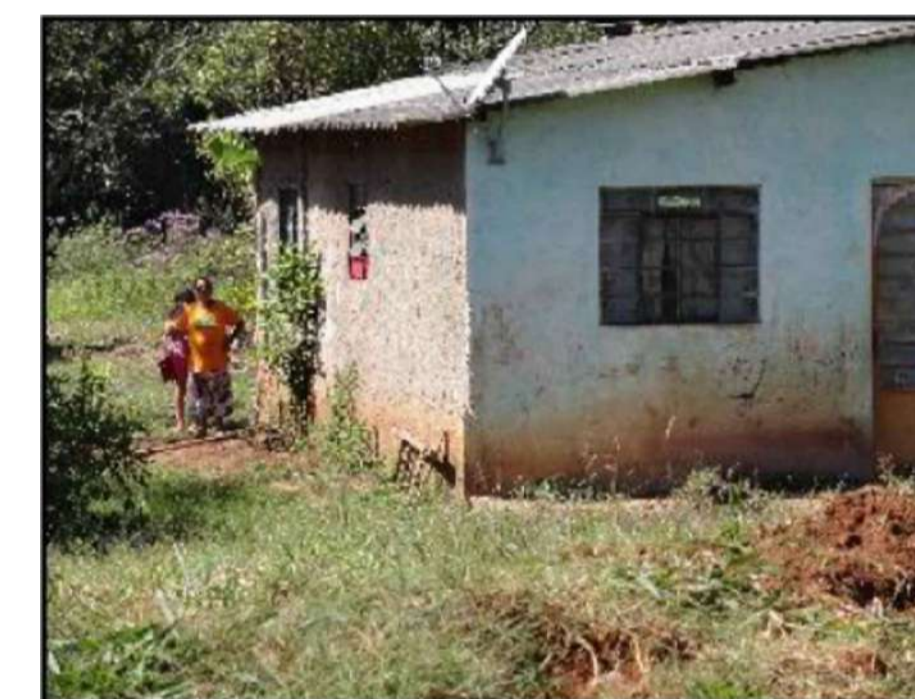
Fonte: Adaptado Relatório IPT. Detalhe da moradia atingida pela inundação, marca do nível da água de aproximadamente 0,7m.
