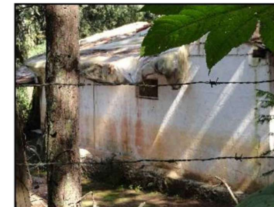
Fonte: Adaptado Relatório IPT. Detalhe da moradia atingida pela inundação.
