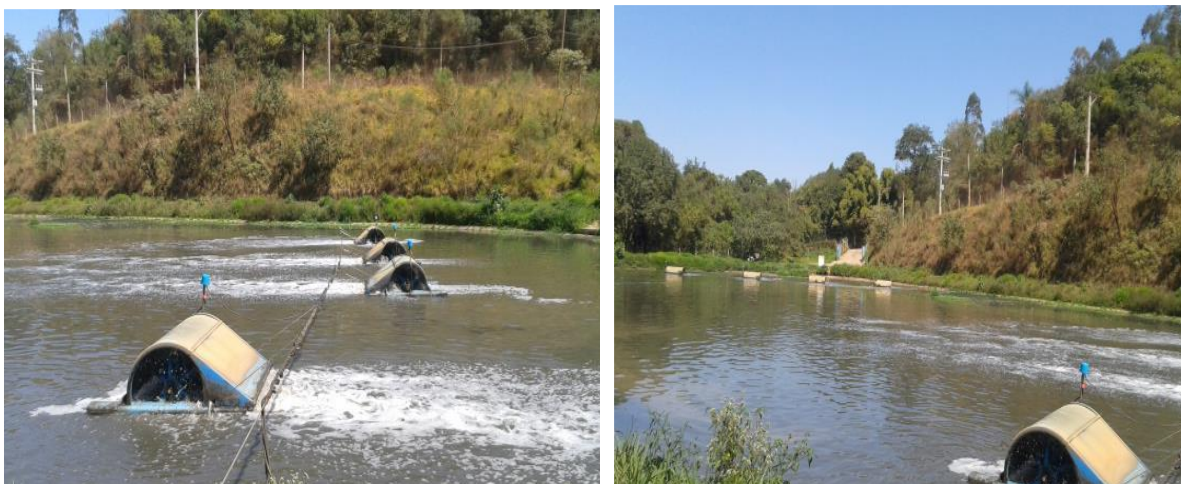
Figura 24 - Lagoa Anaeróbica – ETE Jarinu/SP Fonte: B&B Engenharia, 2014.
