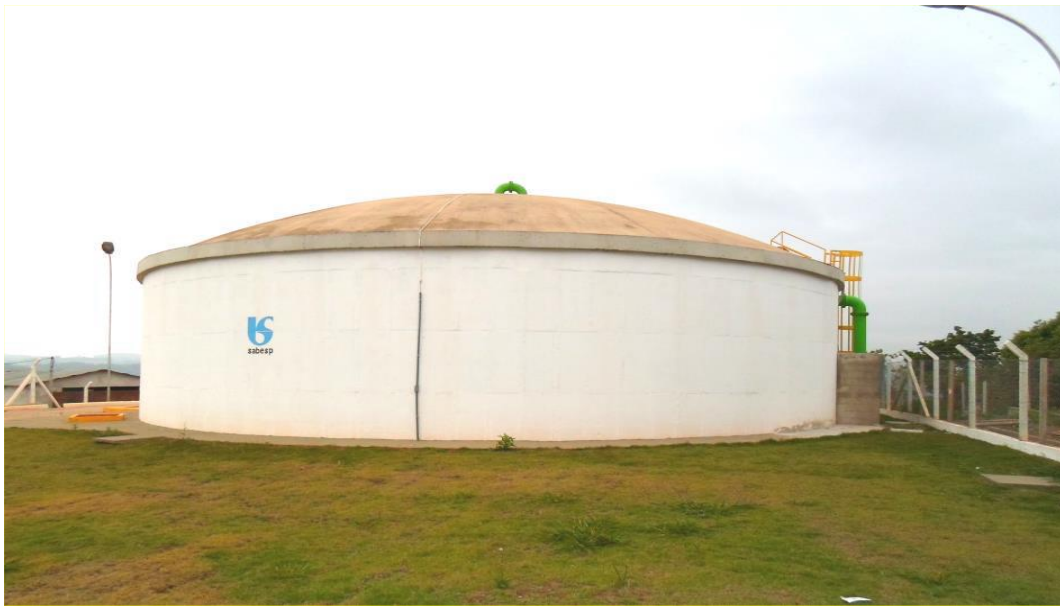
Figura 20 - Reservatório 7 – Nova Trieste - Jarinu/SP
