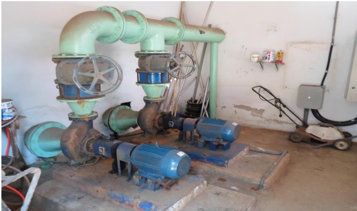
Figura 17 - Sistema EEAB - Estação de Elevatória de Água Bruta
