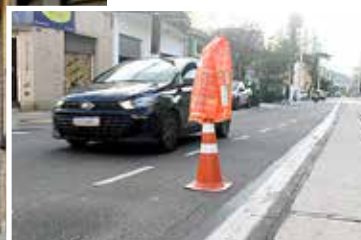
Retratos do dia a dia Comércios fechados, casas escoradas e rachaduras no asfalto são consequências das obras do VLT
