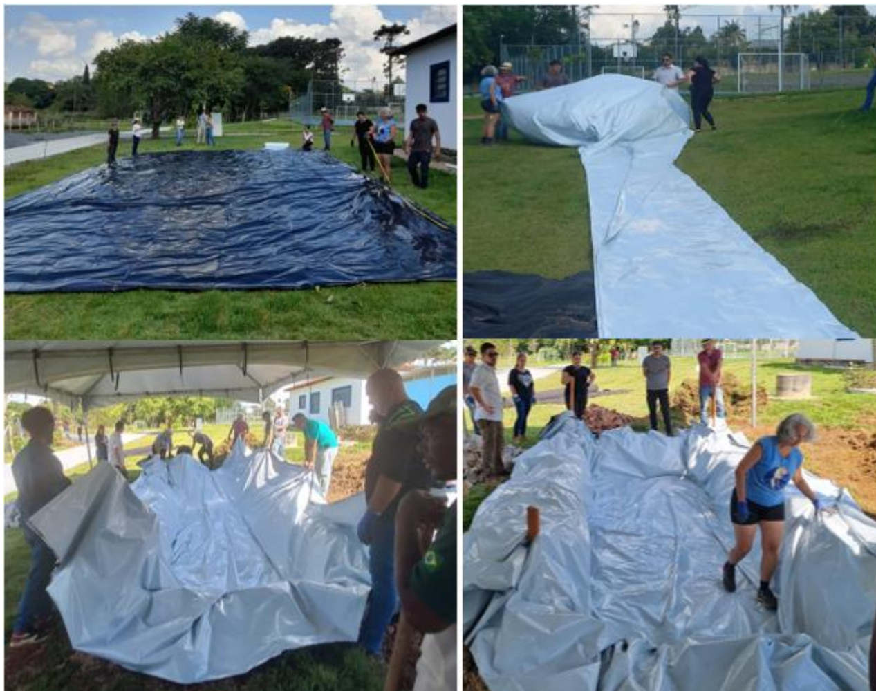
Imagem 2. Abertura, medição, corte, dobramento e colocação da lona. Fonte: acervo prefeitura (oficina de saneamento ecológico realizado em março/2024 no Pq. Castelinho).
