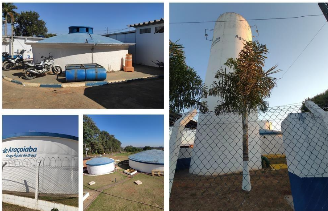
Figura 45 - Modelo de CR instalados na sede municipal
