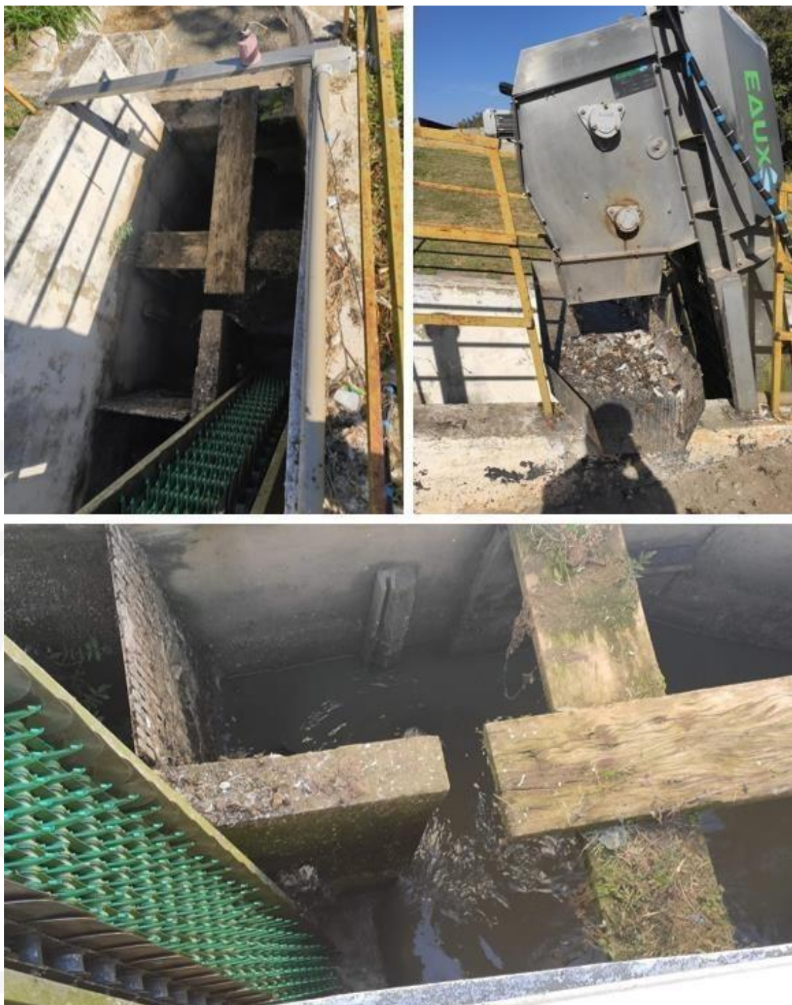
Figura 54 - Entrada de esgoto bruto e tratamento preliminar da ETE Vacariú
