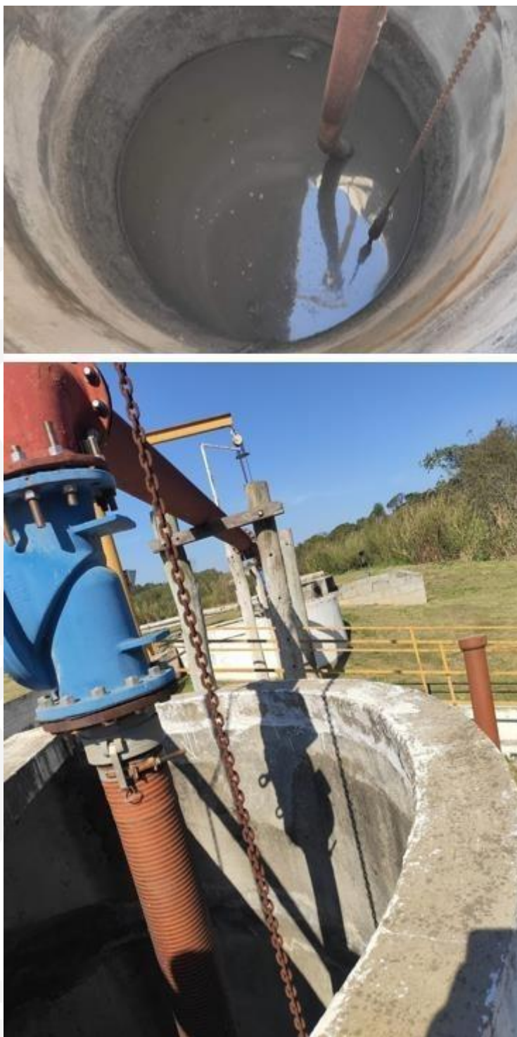
Figura 53 - Estações Elevatórias de Esgoto na entrada da ETE Vacariú
