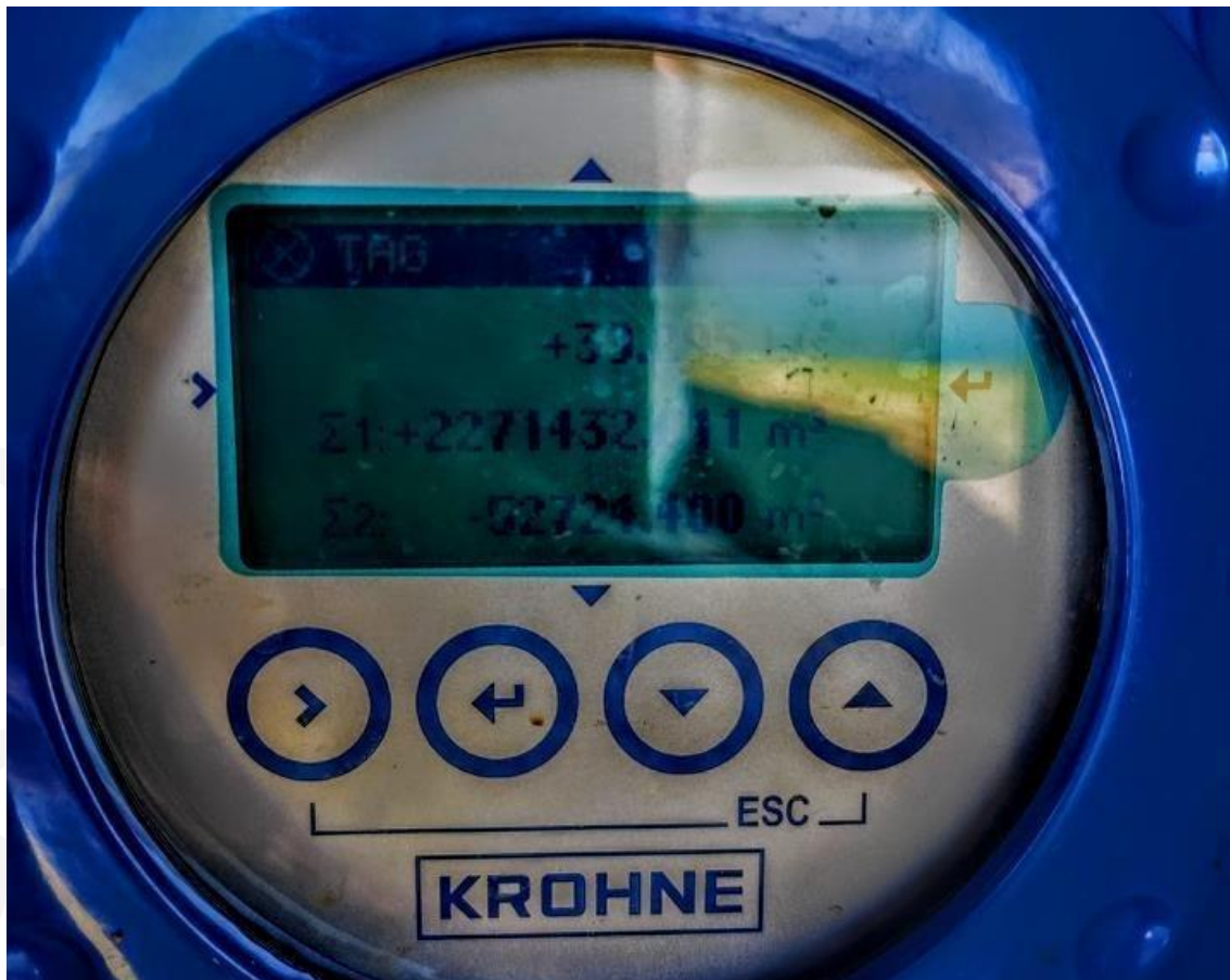
Figura 52 - Medidor de vazão na entrada da ETE Vacariú
