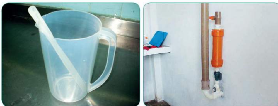
Figura 28 – Recipiente de preparo de solução e clorador instalado.
