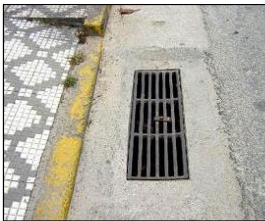
FIGURA 48 – Boco de lobo de sarjeta.
