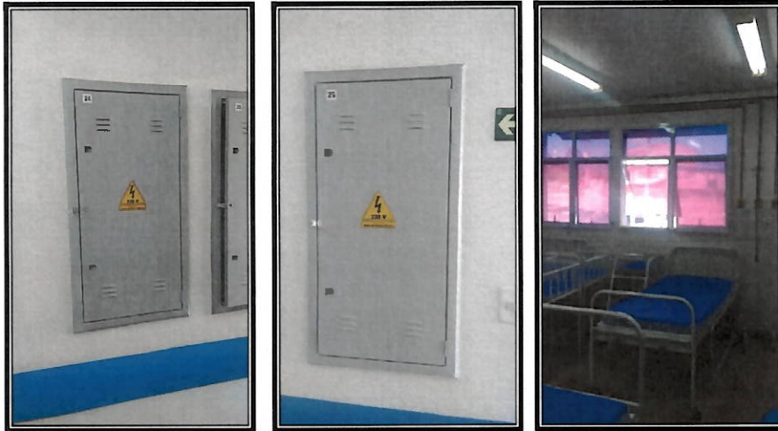
39. Elétrica, ambiente – corredor, maternidade 2
