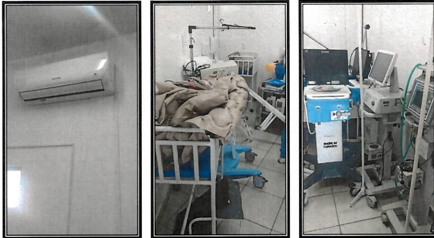
44. Ar condicionado, Ambiente – sala em frente a área de luz
