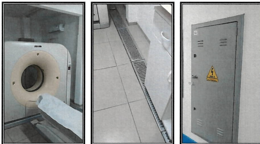
29. Ar condicionado, hidráulica, elétrica – sala da tomografia, corredor
