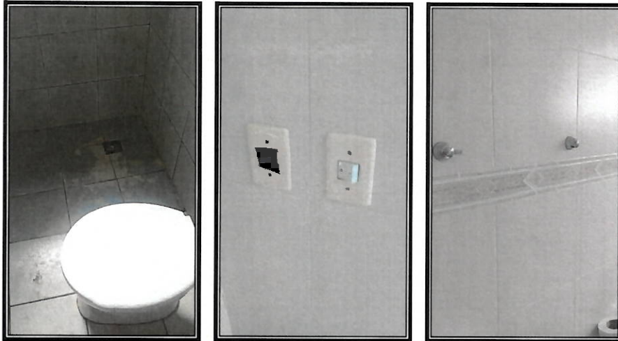
49. Hidráulica, ambiente – quarto 7
