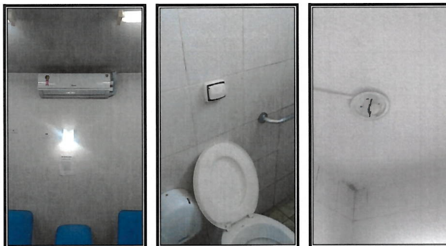
40. Ar condicionado, hidráulica, iluminação – maternidade 2
