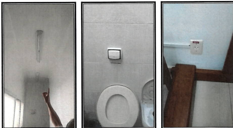
37. Iluminação, hidráulica, elétrica – vestiário após centro cirúrgico, capela
