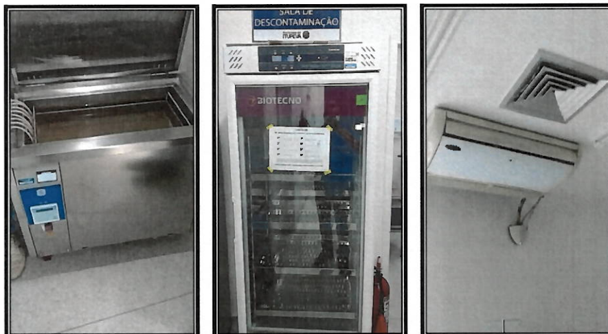
31. Ambiente, Ar condicionado – sala de descontaminação, sala de cirurgia 1
