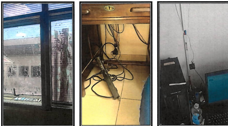
56. Ambiente, elétrica – almoxarifado
