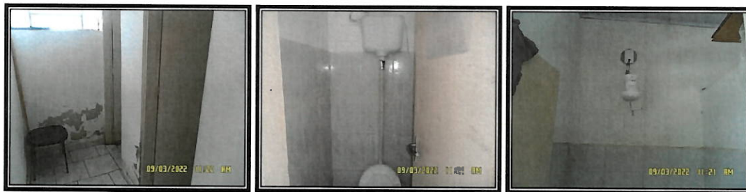
66. Ambiente, hidráulica – Vestiário masculino
