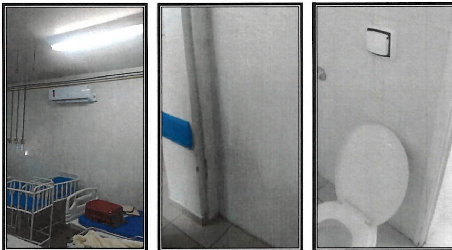
41. Ar condicionado, ambiente, hidráulica – maternidade 1, pré-parto
