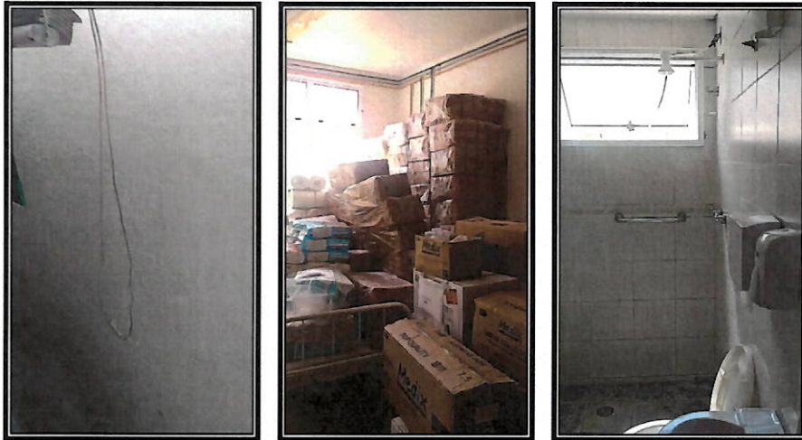
57. Ambiente, hidráulica – almoxarifado, quarto 11
