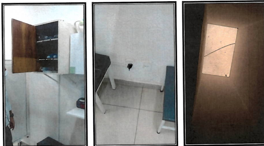
16. Instalação, ambiente – sala do raio X, banheiro
