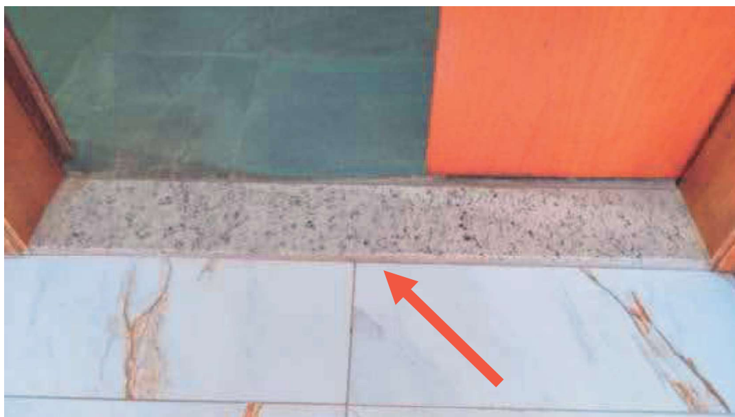
FOTO 134: Soleira da porta do banheiro tem desnível de 1,5 cm sem tratamento especial.
