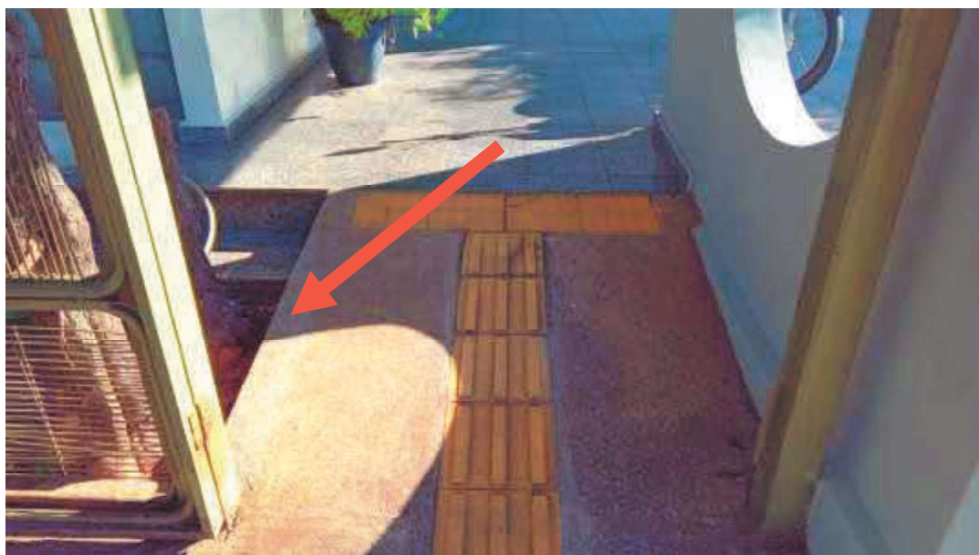
FOTO 131: Rampa (não possui guarda-corpo, corrimão e guia de balizamento).
