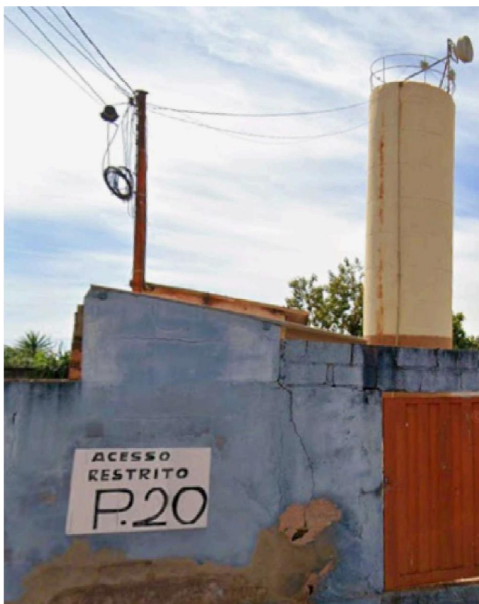
FIGURA 11 – POÇO 20 E RESERVATÓRIO
