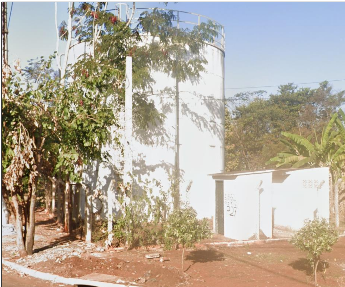
Figura 42 – Poço P 27 – Alameda Geraldo Isaías Ferreira, s/n.
