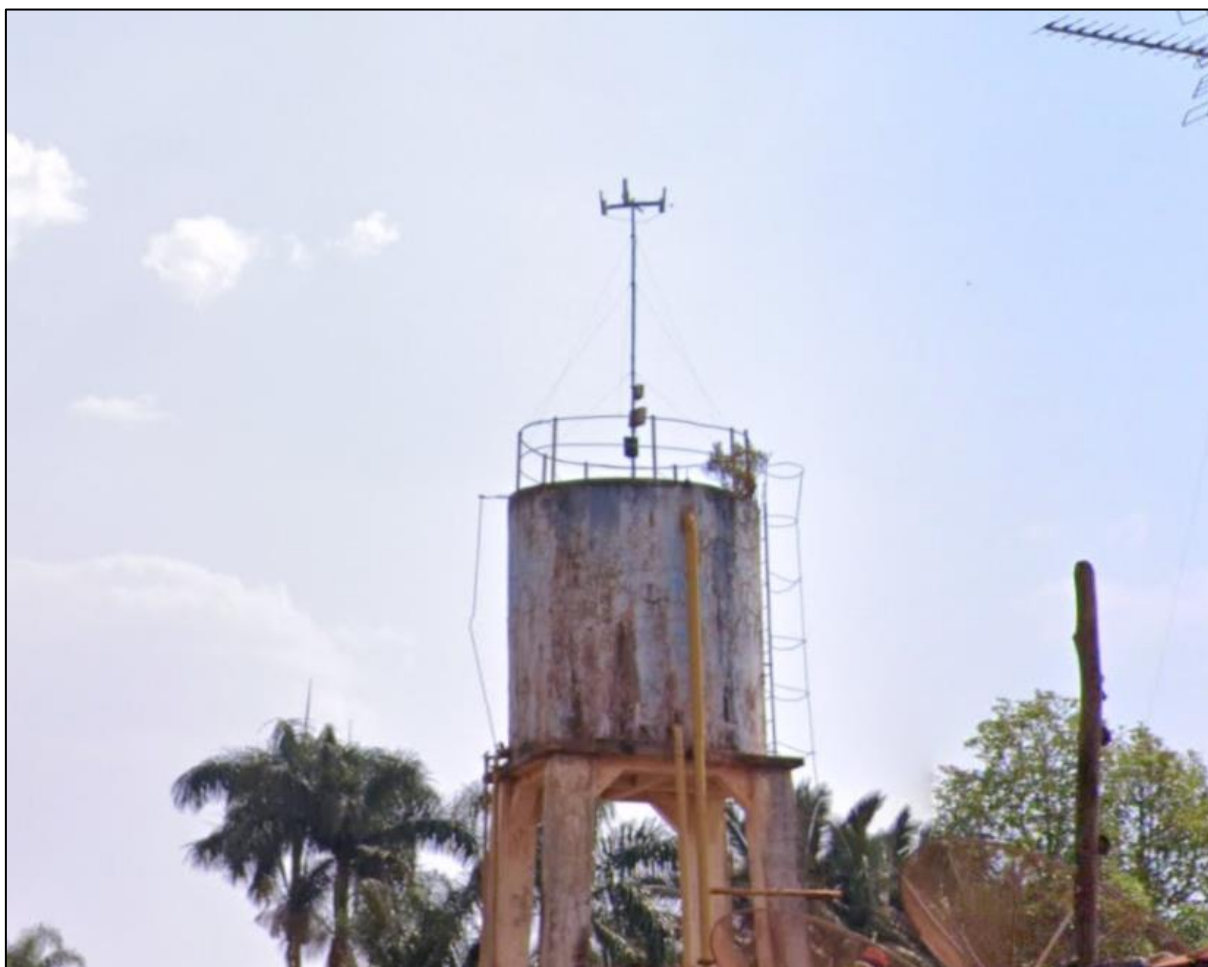
Figura 53 – Reservatório R 10 – Rua Eugênia Viel Biagi, s/n.
