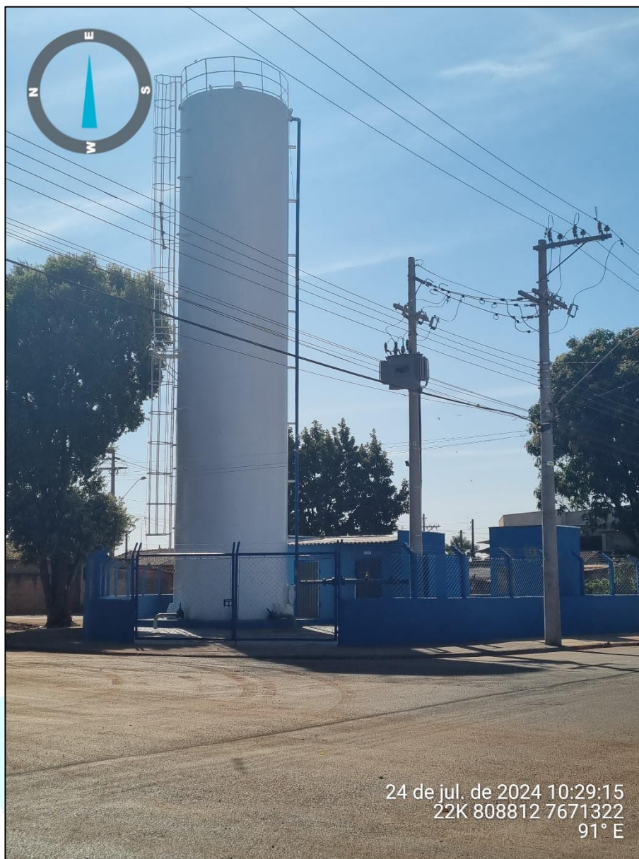
Figura 60 – Reservatório R 17 – Rua Alcebiades Spinola, s/n.
