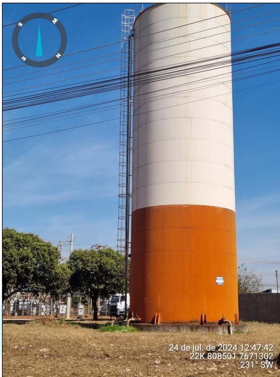
Figura 51 – Reservatório R 08 – Avenida Cristo Redentor, s/n.
