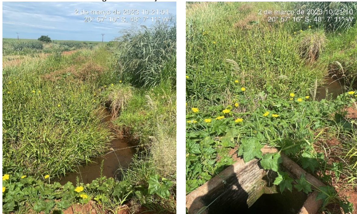
Figura 70 - LANÇAMENTOS INDEVIDOS DE ESGOTO
