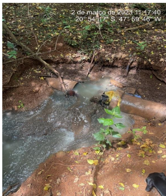
Figura 72 - TUBULAÇÃO DANIFICADA DA ETE
