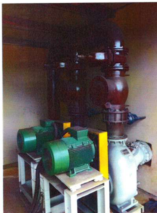
Figura 4: Estação Elevatória ETE – Pontal
