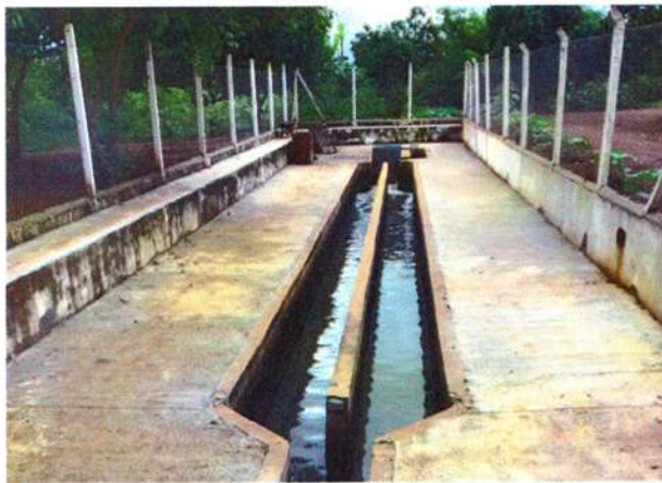
Figura 2: Caixa de Areia ETE - Pontal
