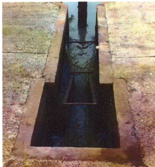
Figura 3: Calha Parshall ETE - Pontal
