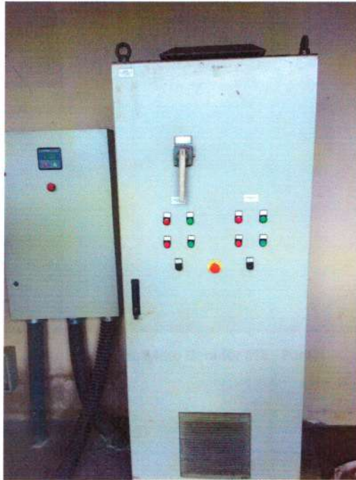
Figura 5: Painel Elétrico ETE - Pontal
