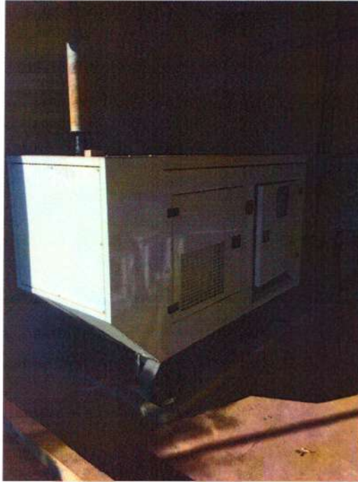
Figura 6: Grupo Moto Gerador ETE - Pontal
