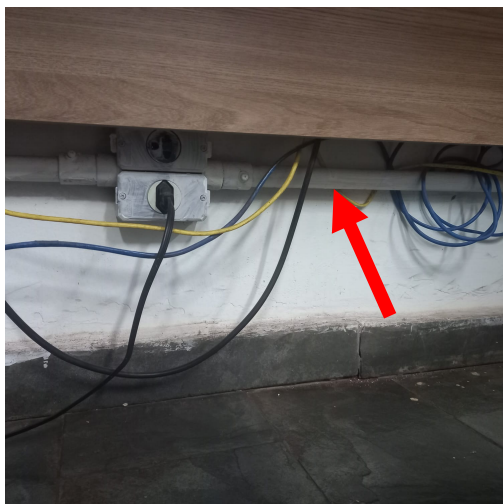
Foto 3 – Tubulações a ser removida
