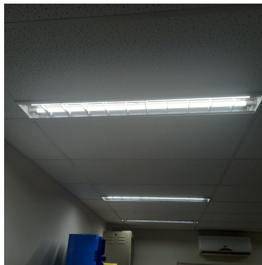
Foto 2 – Modelo Luminárias Existentes
