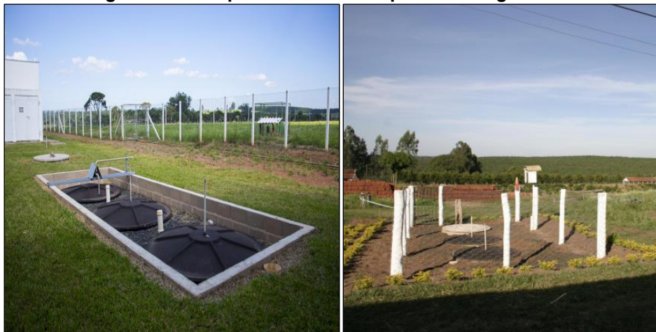
Figura 9 - Exemplos de Fossas Sépticas Biodigestoras.
