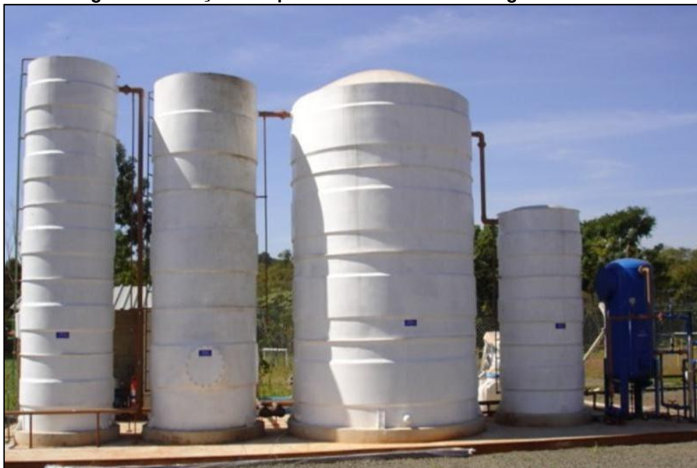
Figura 7 - Estação compacta de tratamento de esgoto sanitário.
