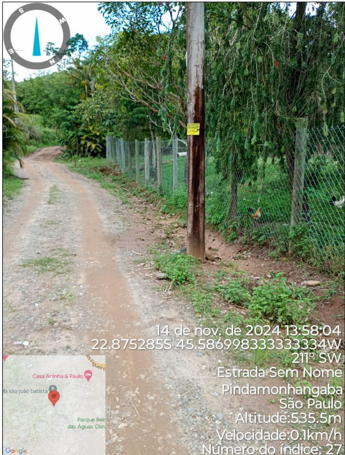
Figura 33 - Pedras utilizadas para o melhoramento da via carreadas pela água da chuva.
