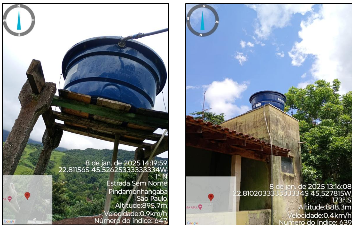
Figura 15 - Reservatório elevado ligado a encanamentos na área rural de Pindamonhangaba.
