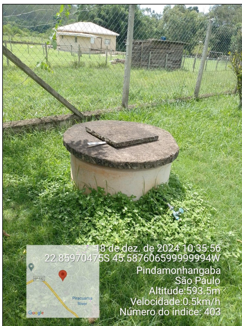
Figura 13 - Poço com altura na abertura visando impedir entrada de águas pluviais.
