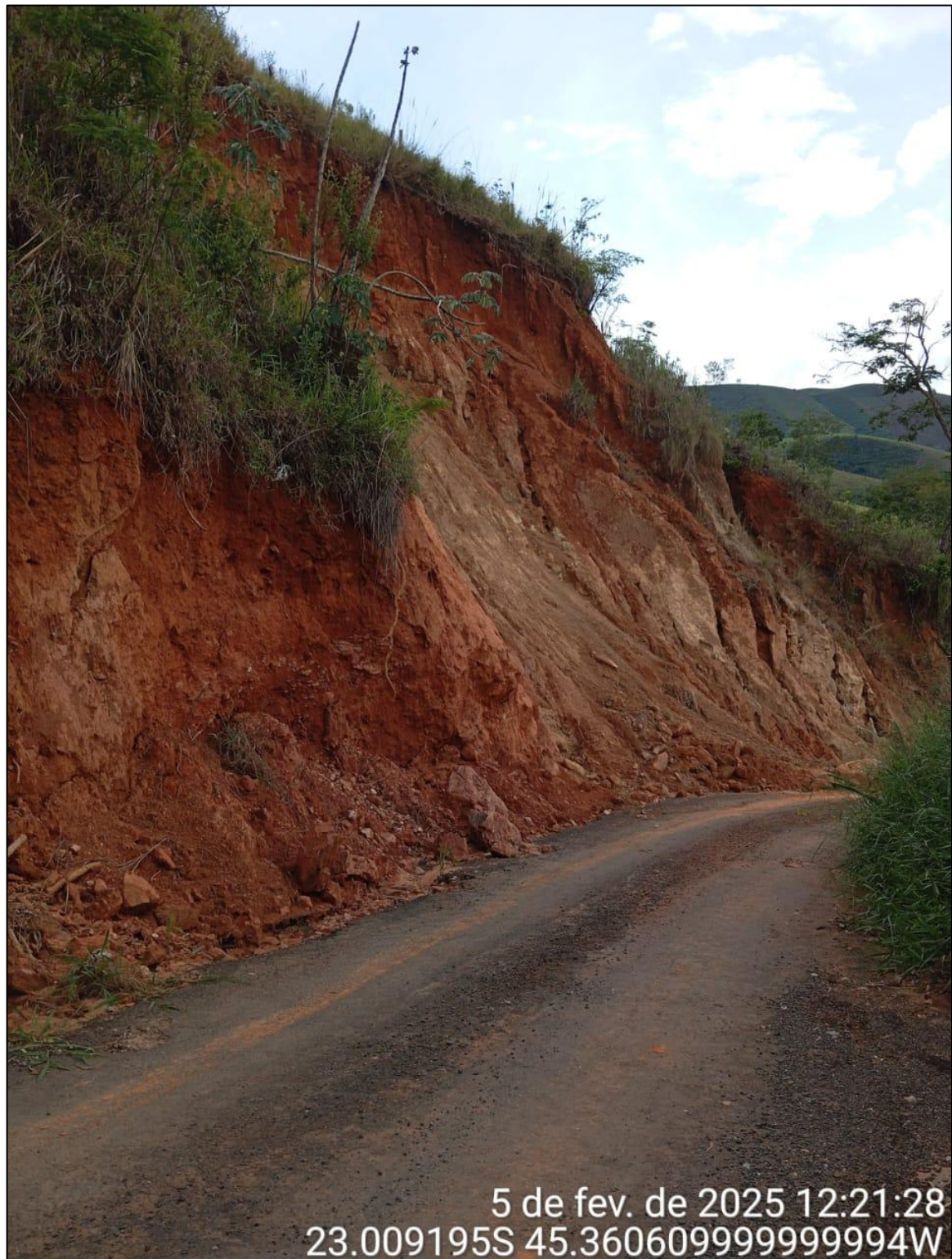
Figura 40 - Processos erosivos nas estradas rurais do município.
