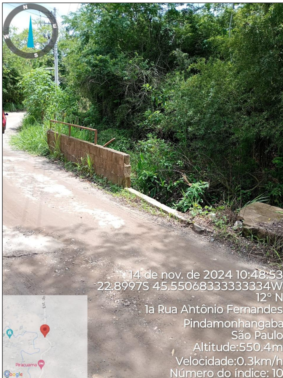
Figura 35 - Estrutura da ponte danificada.
