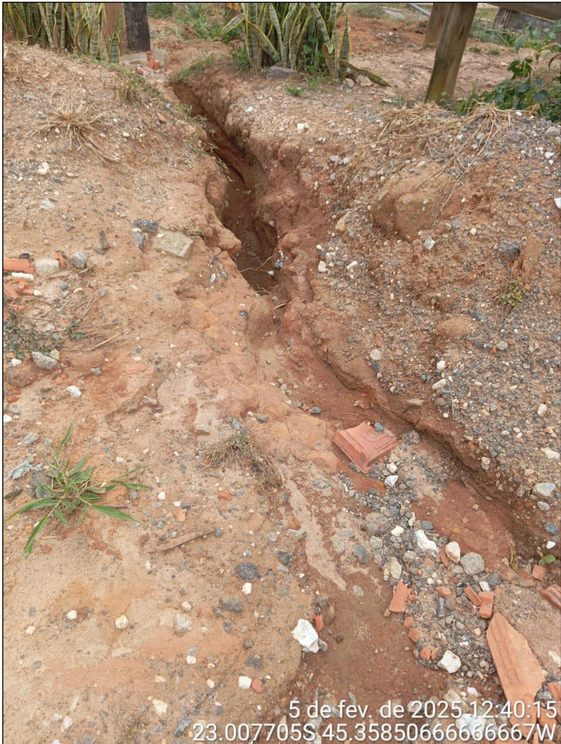
Figura 39 - Processos erosivos nas estradas rurais do município.
