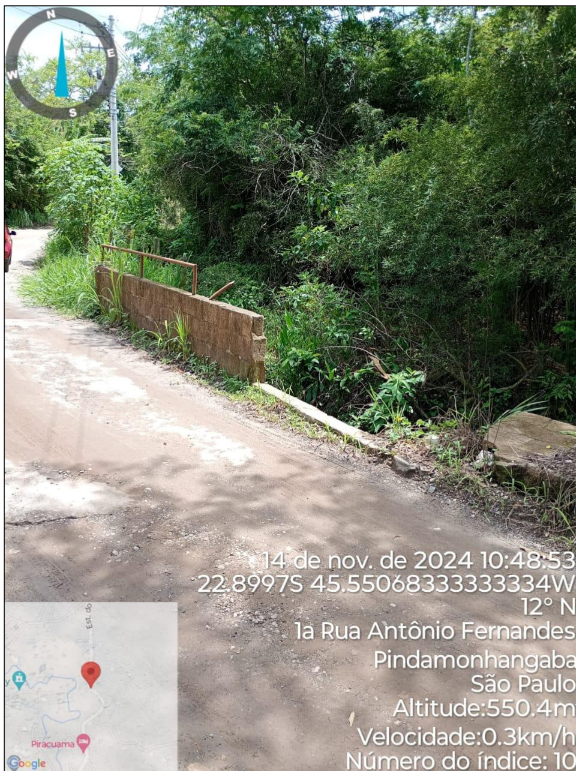
Figura 35 - Estrutura da ponte danificada.
