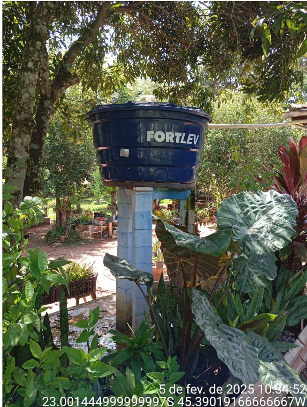
Figura 12 - Reservatório de água da chuva utilizado para abastecimento de água na zona rural de Pindamonhangaba/SP.
