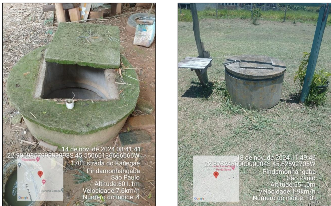
Figura 14 - Poços com a tampa devidamente vedada e em boas condições.
