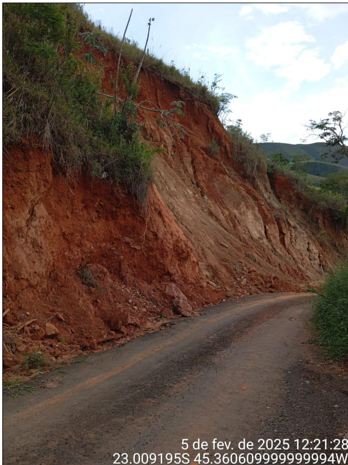
Figura 40 - Processos erosivos nas estradas rurais do município.
