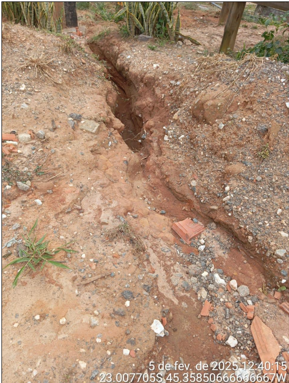
Figura 39 - Processos erosivos nas estradas rurais do município.
