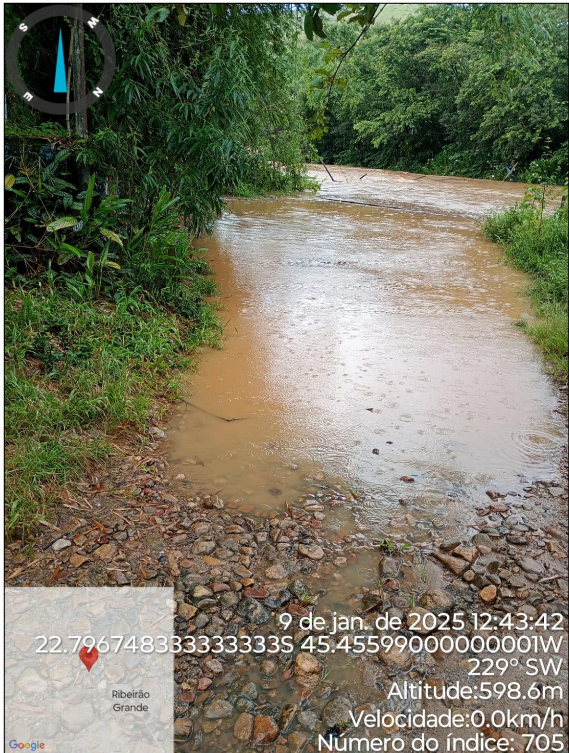
Figura 34 - Drenagem insuficiente para escoar a água.
