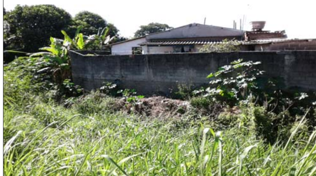
Foto: 1651756174488.jpg ID: 25 Evidência de movimentação em estruturas, Formação de processo erosivo, Lançamento de águas/esgoto na superfície, Moradia sujeita a risco de solapamento
