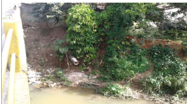
Foto: 1651599825497.jpg ID: 13 Detalhe para processo de solapamento no talude, Presença de cicatriz de escorregamento pretérito, Formação de processo erosivo
