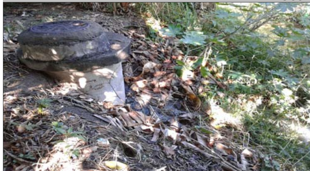
Foto: 1651753730922.jpg ID: 21 Detalhe para processo de solapamento no talude, Presença de vazamento de tubulação de água/esgoto
