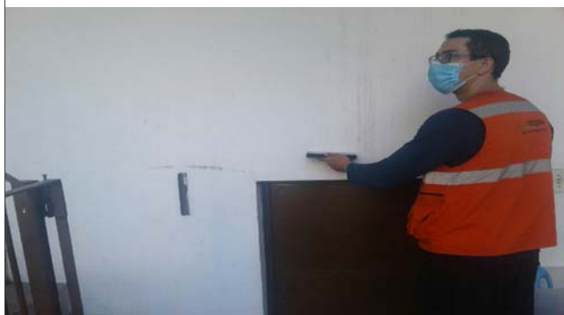
Foto: 1651496179970.jpg ID: 12 Imóveis afetados pelo processo, Detalhe para marca de água
