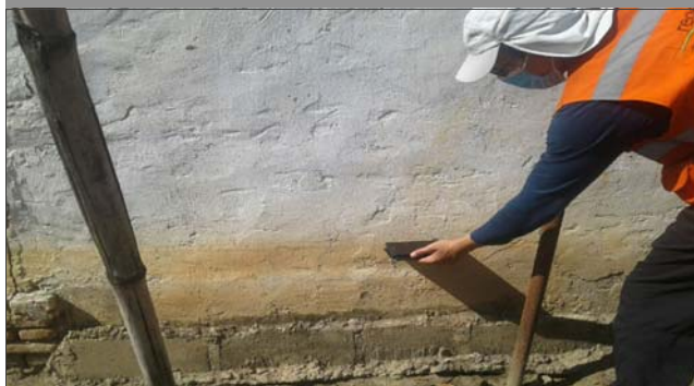
Foto: 1652103789071.jpg ID: 21 Imóveis afetados pelo processo, Detalhe para marca de água
