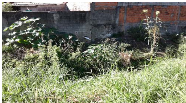
Foto: 1651756021806.jpg ID: 24 Presença de cicatriz de escorregamento pretérito, Evidência de movimentação em estruturas, Formação de processo erosivo, Lançamento de águas/esgoto na superfície, Moradia sujeita a risco de solapamento
