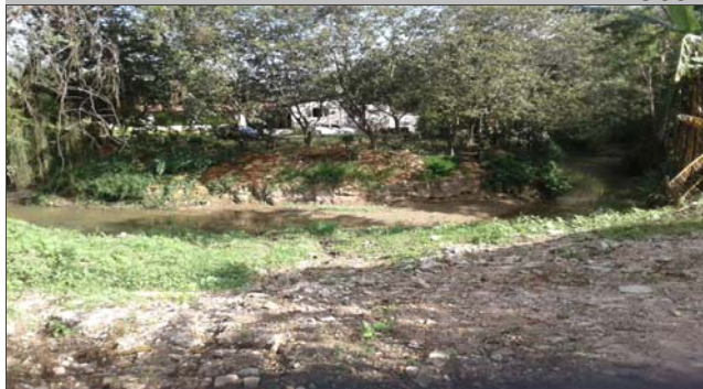
Foto: 1651599142477.jpg ID: 11 Visão geral da drenagem, Presença de cicatriz de escorregamento pretérito, Formação de processo erosivo
