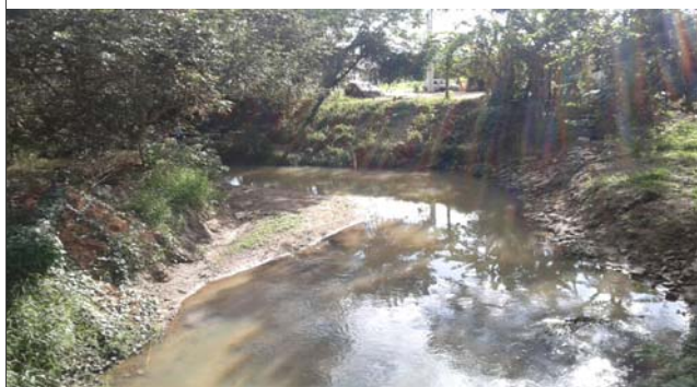
Foto: 1651599644693.jpg ID: 12 Detalhe para processo de solapamento no talude, Presença de cicatriz de escorregamento pretérito, Formação de processo erosivo
