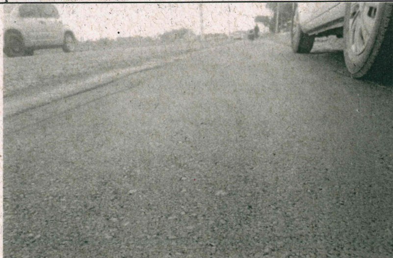
FOTO 10 – Rua Francisco Ferreira da Cruz – Pavimento refeito em desnível com o existente
