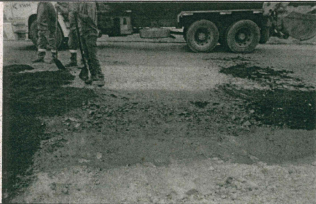
FOTO 08 – Rua Francisco Ferreira da Cruz – Sujeira presente na área a ser pavimentada – Aplicação de camada em CBUQ sem devida compactação do solo e desnível com o existente.
