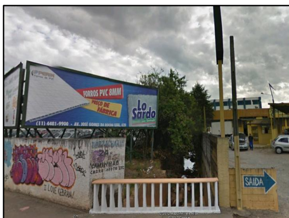
Figura 13.3- Seção 193: Margem desprotegida.
