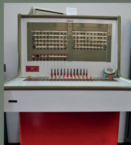
Mesa de operação manual, fabricação brasileira, marca Telequipo. Funcionou no Grande Hotel Bragança de julho de 1977 a novembro de 1995.
