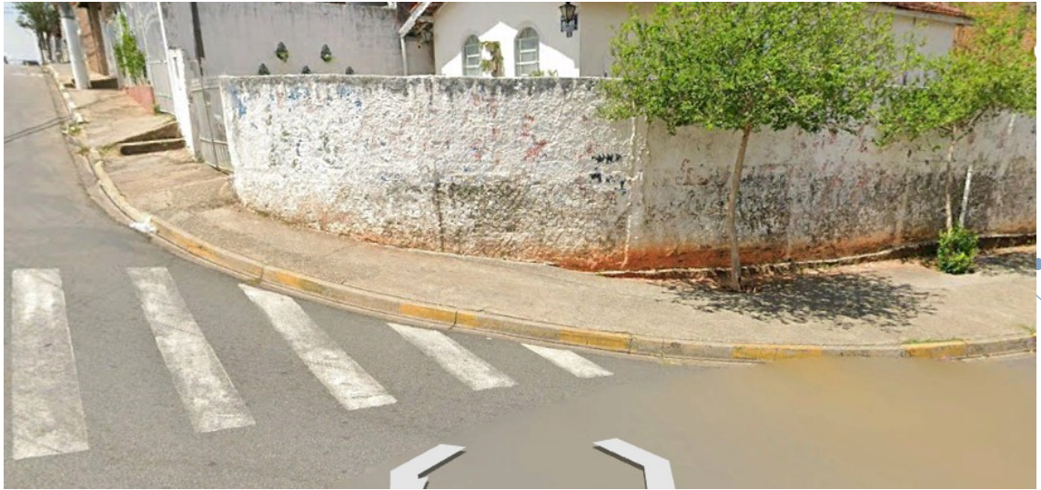
Foto de calçada sem rebaixamento e sem piso tátil
