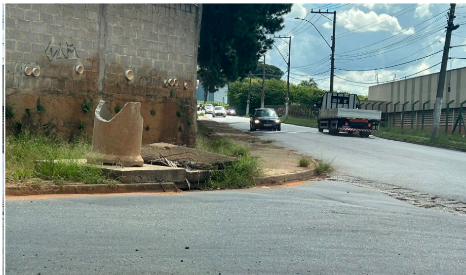
Imagem 31: calçada no cruzamento da Avenida Nossa Senhora da Penha x Rua Expedicionário José Franco de Macedo. Data: 20/03/2024
