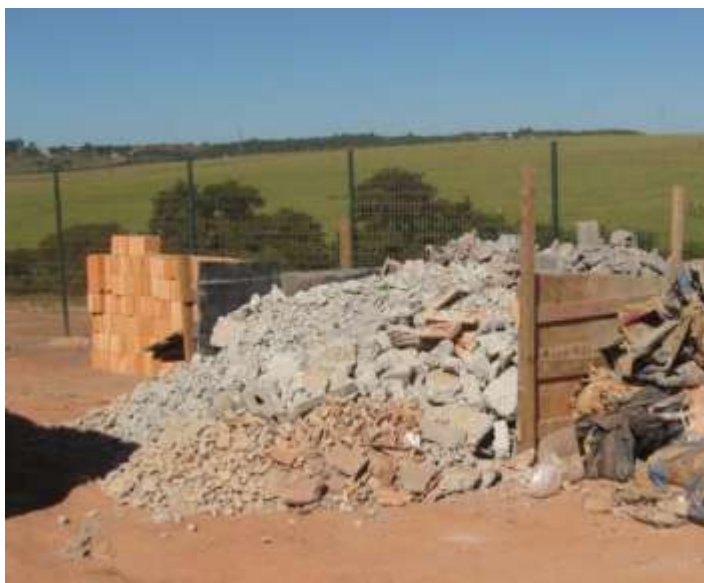
FIGURA 5: Exemplo de baia para entulho e madeira.
