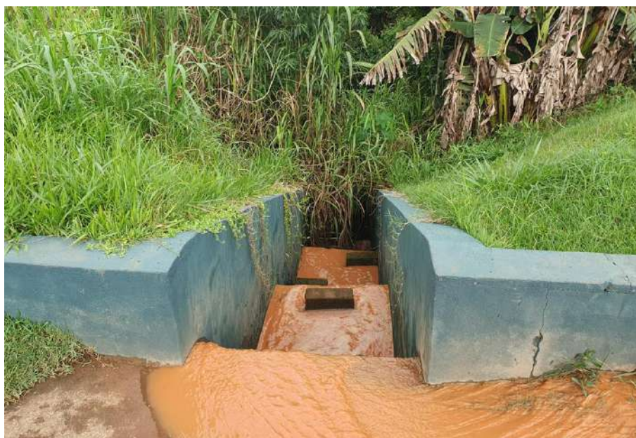
Figura 19: Equipamento de dissipação de energia da água escoada. Fonte: Master Ambiental.
