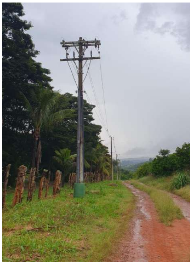
Figura 17: Rede de energia no interior do lote do empreendimento. Fonte: Master Ambiental.
