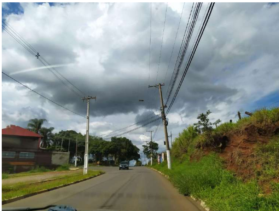
Figura 56 – Rede elétrica na Avenida Atílio Menin.
