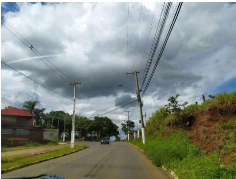
Figura 56 – Rede elétrica na Avenida Atílio Menin.
