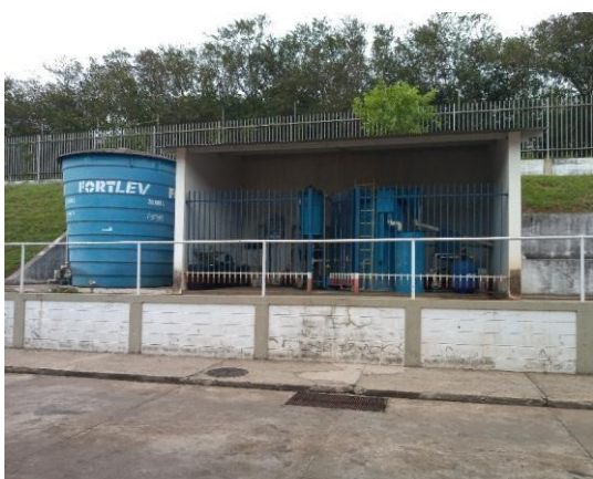
Figura 133 - Sistema de captação e reuso da água da lavagem externa.
