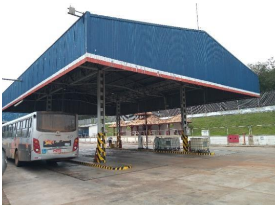
Figura 131 - Ponto de Abastecimento
