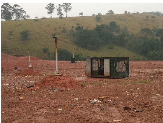
Figura 168 - Queimadores de gás.
