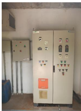
Figura 89 -Elevatória com 2 bombas sendo 1 reserva.
