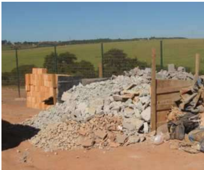
FIGURA 5: Exemplo de baia para entulho e madeira.
