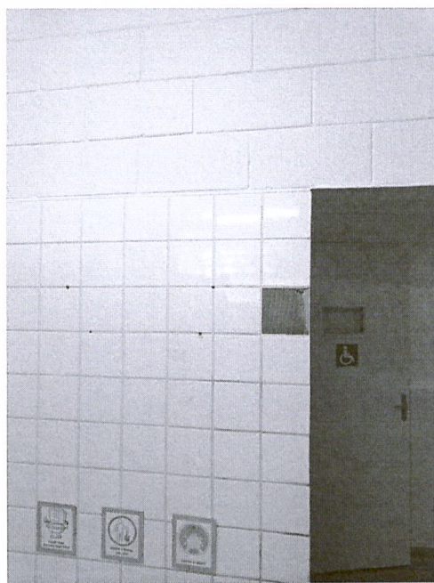
Azulejo faltante em um dos banheiros.
