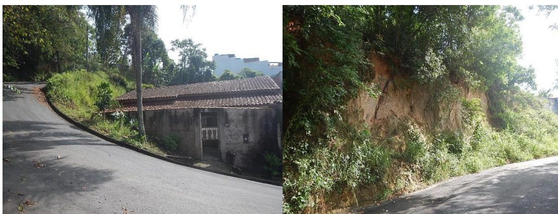
Figura 4: Casa próxima à talude de corte, mas que encontra-se estável atualmente, necessitando de monitoramento (Rua Carlos J. de Moraes). Figura 5: Deslizamentos recentes, com talude negativo à Rua Carlos J. De Moraes.
