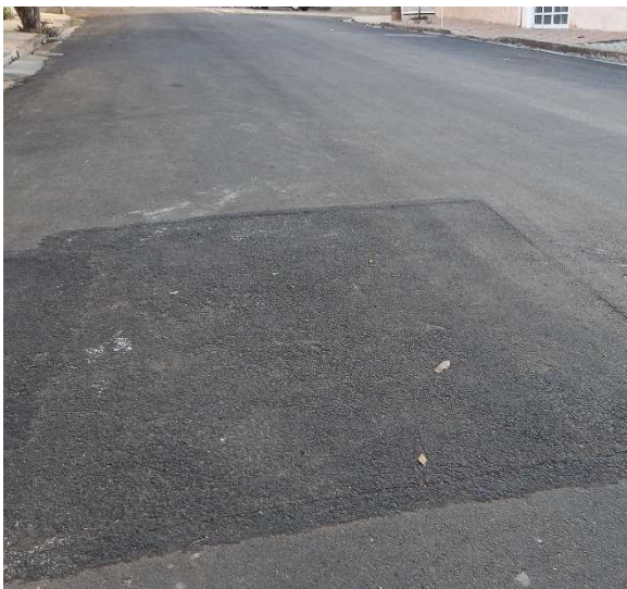
Figura 92 - Condições de Pavimentação 3
