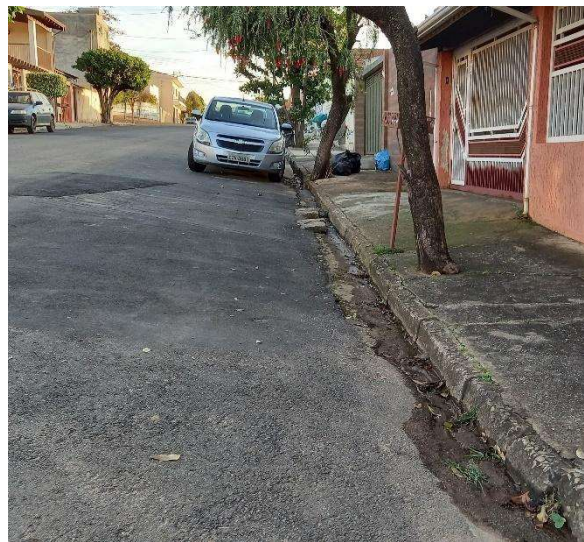
Figura 93 - Condições de Pavimentação 4
