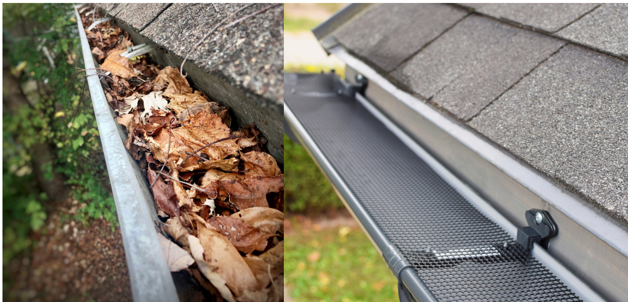
Fig. 12 - Calha cheia de folhas e calha com tela filtro instalada. Fonte: Imagens disponíveis no Canva, 2024.
