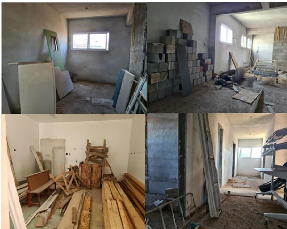
Restos de materiais de construção e de mobiliário no interior do edifício
