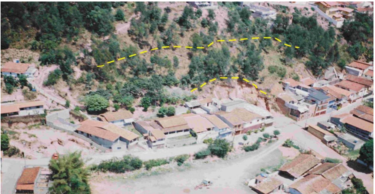
Figura 08. Parte da área A3S1R4, com destaque para degrau de abatimento e cicatriz de escorregamento na encosta.
