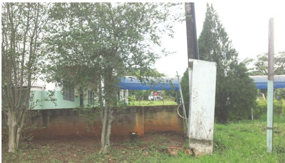
Caixa de Energia antes da reforma (inclinada)
