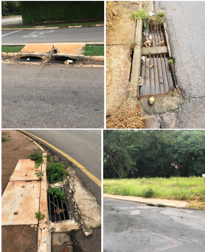
Figura 7-3 - Exemplos de dispositivos de captação de águas pluviais em Tatuí com necessidade de manutenção e limpeza Fonte: CONSÓRCIO CM (2021)
