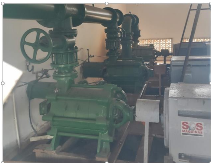
Figura 4-9 – Conjunto moto bombas da EEAB2 (Trapiche) Fonte: CONSÓRCIO CM (2021)
