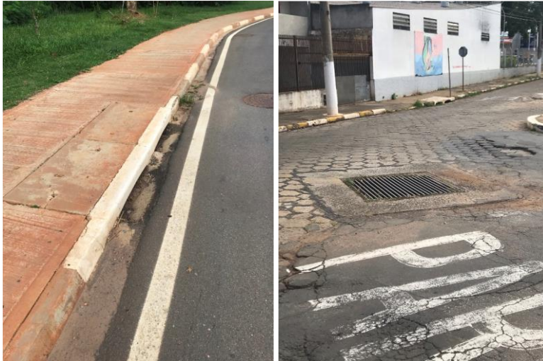
Figura 7-4 - Exemplos de dispositivos de captação de águas pluviais em Tatuí em bom estado de conservação Fonte: CONSÓRCIO CM (2021)
