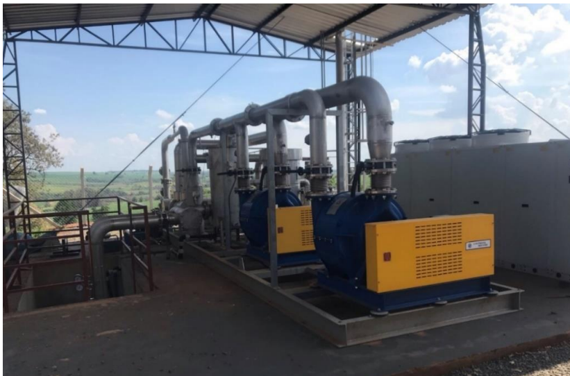
Figura 6-19 - Aterro de Cesário Lange, estrutura gerador biogás Fonte: CONSÓRCIO CM (2021)
