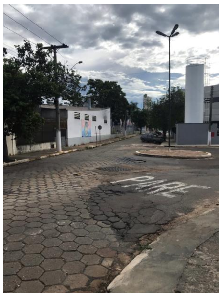
Figura 7-9 - Ponto de alagamento 1 Fonte: CONSÓRCIO CM (2021)
