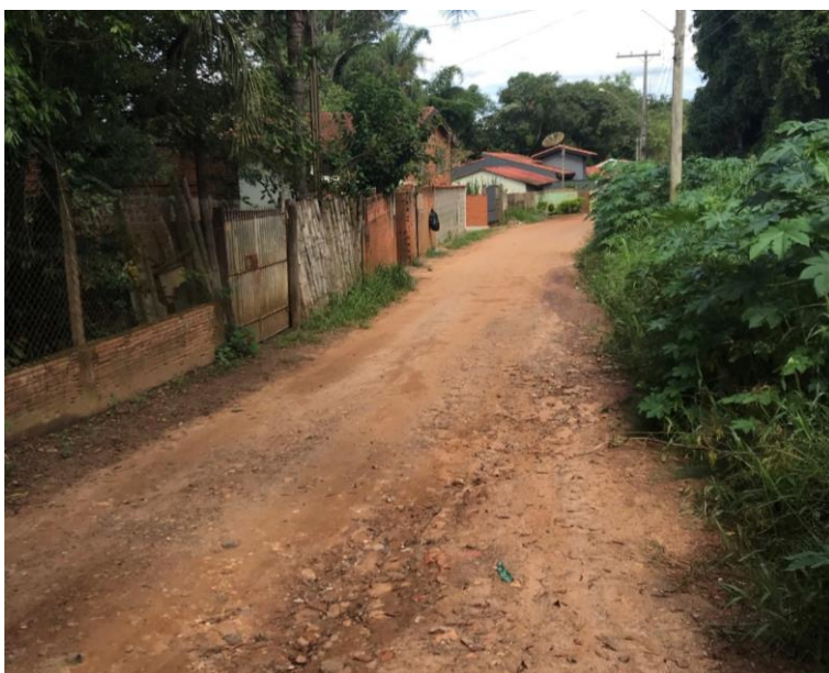
Figura 3-28 - Via sem pavimentação em Tatuí Fonte: CONSÓRCIO CM (2021)
