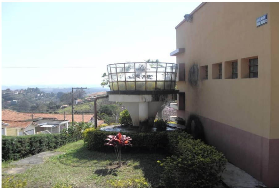
Foto 01 – Chegada de água bruta - Sistema de aeração na ETA Central
