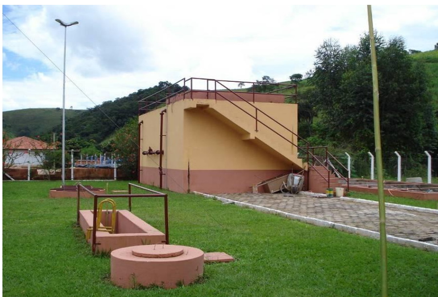
Foto 11 – ETE Campos de Cunha (Fonte: GEL Cunha)
