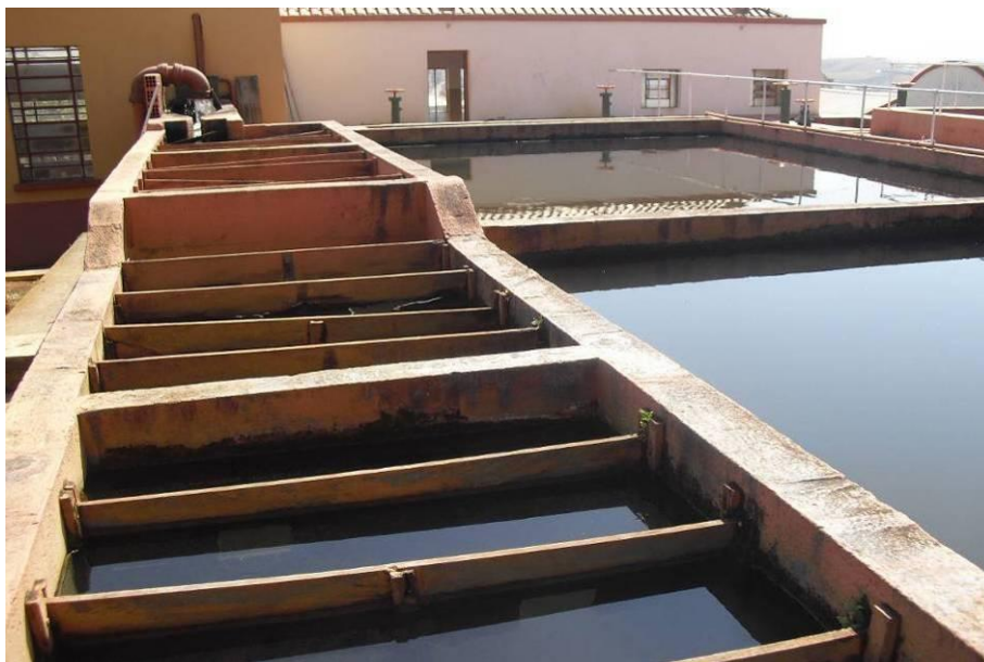
Foto 03 – Floculadores e decantadores da ETA Central de Cunha
