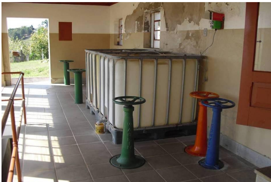
Foto 04 – Armazenamento de produtos químicos da ETA Central de Cunha
