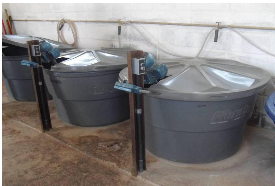
Foto 07 – Tanques de preparo e homogeneização de produtos químicos
