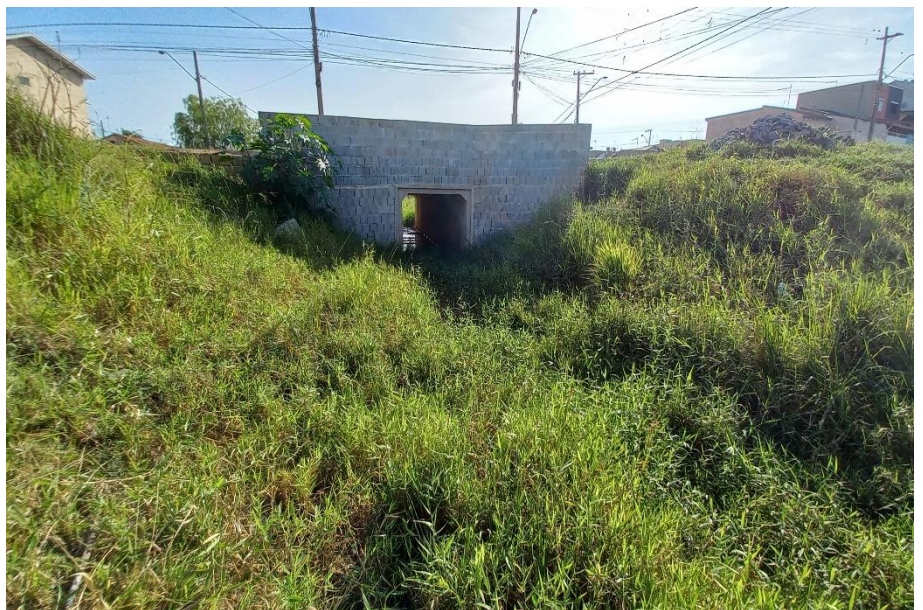
Foto n.º 2 – Aspecto da travessia 02 em observação da jusante para a montante.
