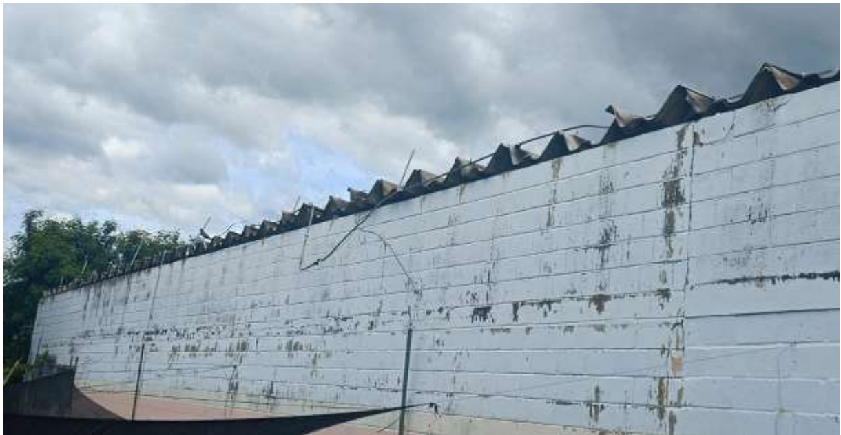
Foto 1. Bloco1, vista dos fundos, onde as telhas desceram;
