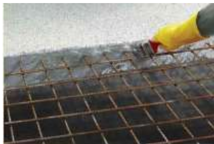
Figura 35 – Colagem entre peças estruturais
