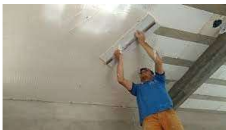
Figura 57 – Forro de Gesso Sarrafeado
