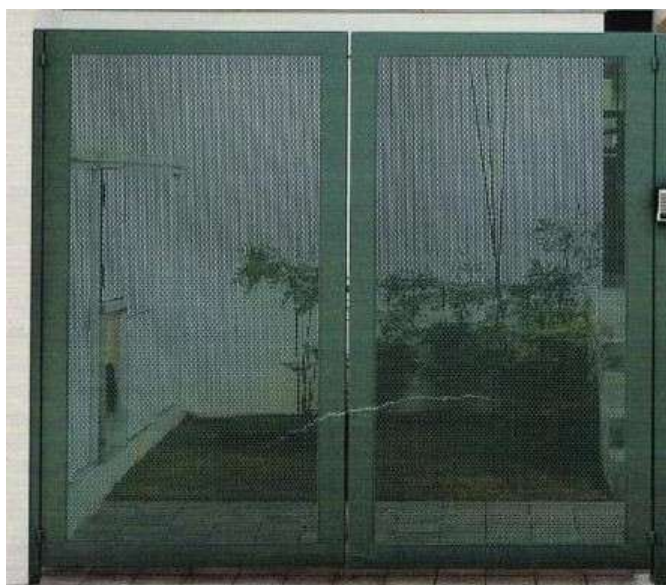
Figura 34 – Portão de Grade – Acesso Externo
