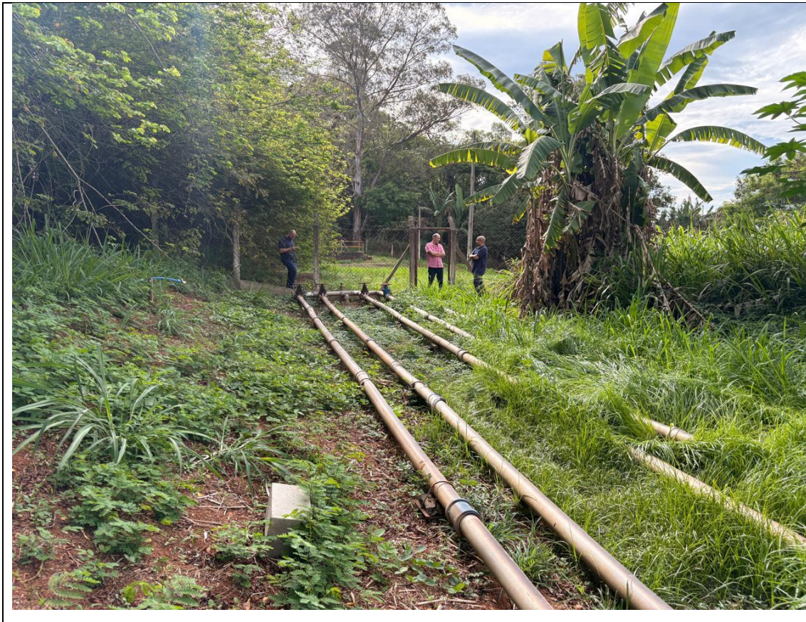
Figura 21. Plantação de bananas na área da ETE Itaqui, irrigada com efluente tratado, demonstrando manejo agrícola sustentável.
