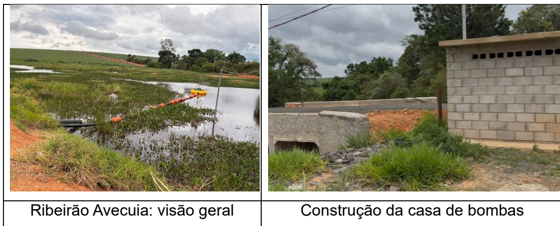
Figura 09. Estação de Captação de Água Angelieri (ECA Angelieri) – Unidade em Implantação, Porto Feliz/SP.
