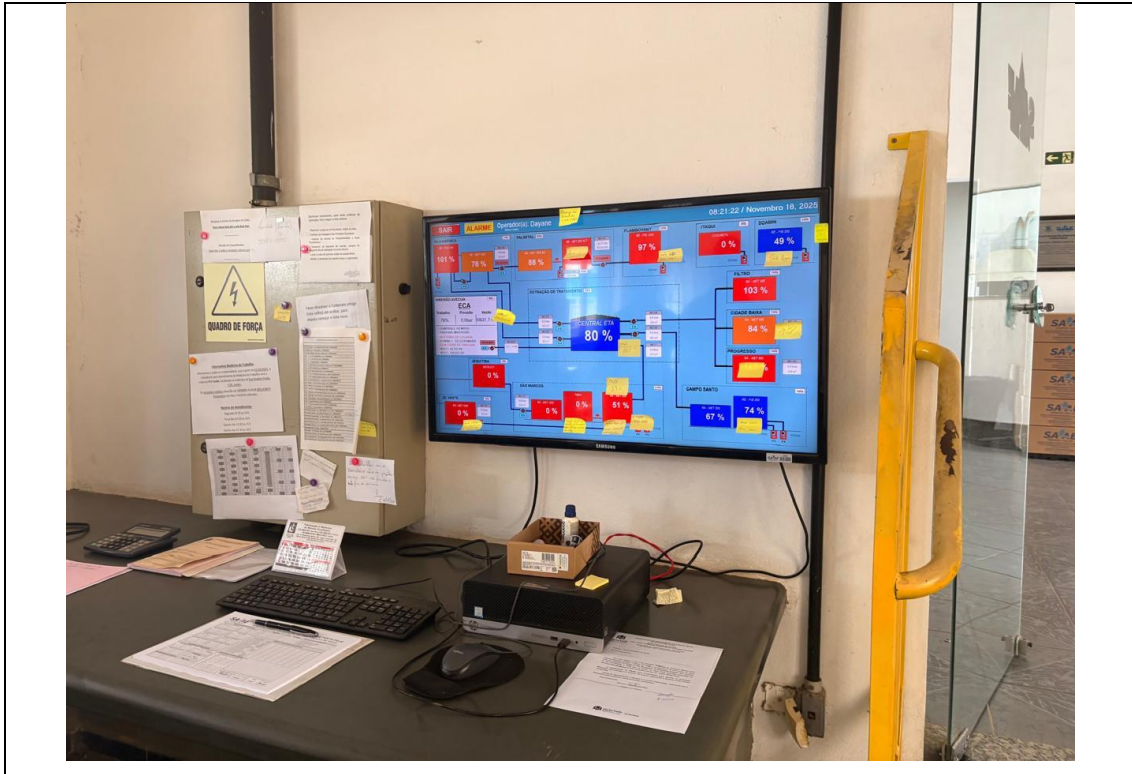
Figura 14. Centro de Controle Operacional da Estação de Tratamento de Água de Porto Feliz/SP.
