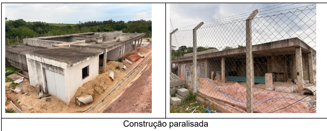
Figura 23. Estação de Tratamento de Esgoto CEMEX (ETE Cemex), Porto Feliz/SP.
