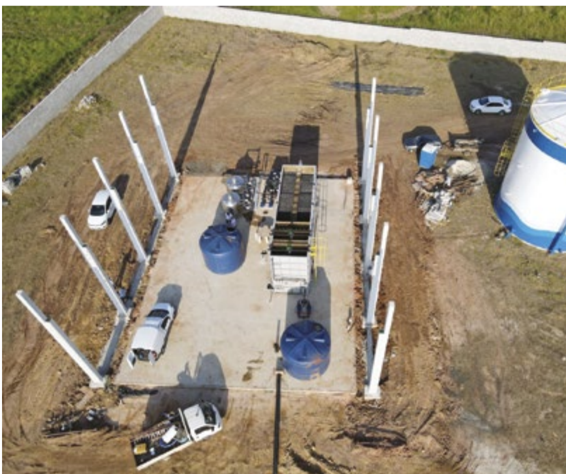
Estação de água em Porto Feliz vai ampliar e melhorar o abastecimento de água no município
