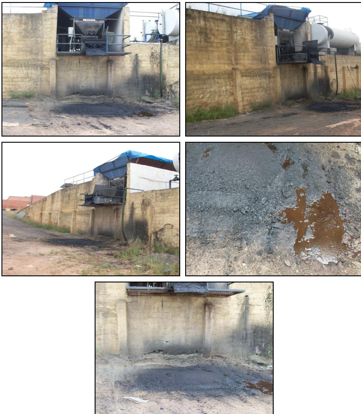
Figura 116 – Restos de asfalto e óleo dispostos inadequadamente.
