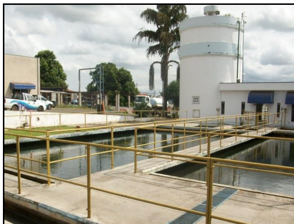
Figura 48 - Estação de tratamento da água.
