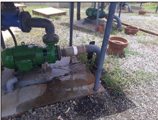
Figura 48 – Bomba localizada no centro de reservação.
