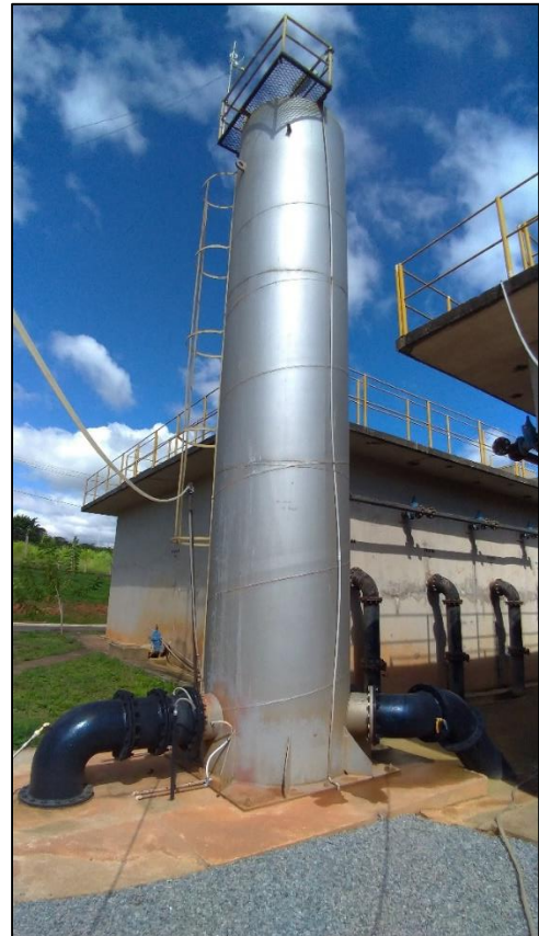
Figura 25 - Torre de mistura de produtos químicos com a água bruta
