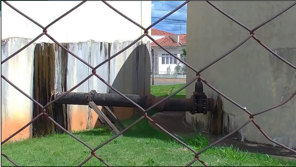
Figura 44 - Reservatórios Jardim Paulista interligados, com vazamentos visíveis.
