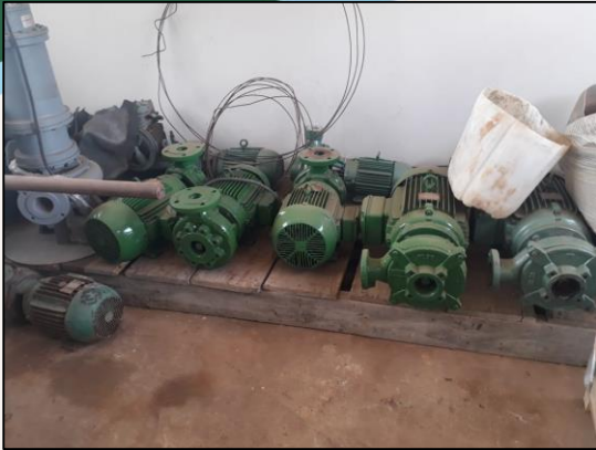
Figura 52 – Local de armazenamento das bombas reservas
