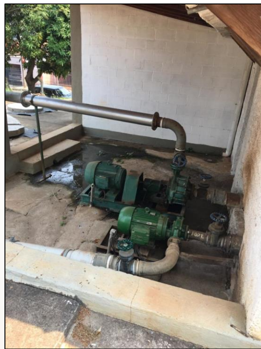
Figura 55 – Bombas apresentando vazamentos
