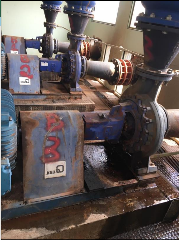
Figura 46 – Vazamentos nas bombas de captação
