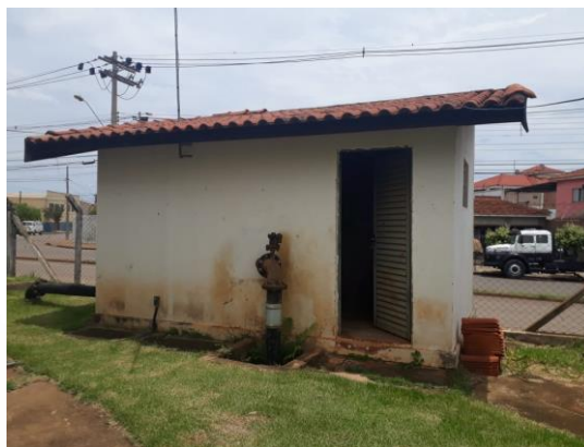
Figura 57 – Casa das bombas
