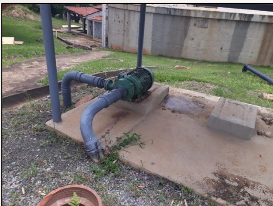
Figura 50 – Bomba localizada no centro de reservação
