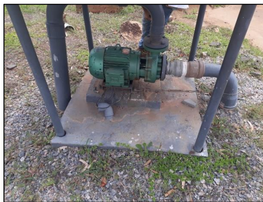
Figura 49 – Bomba localizada no centro de reservação
