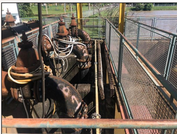
Figura 19 – Tubulação de adução de água bruta
