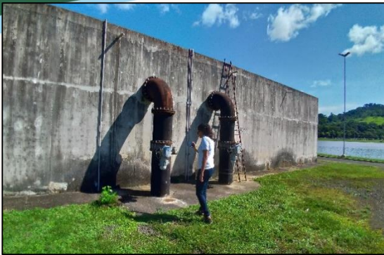
Figura 36 - RA01 (localizado na ETA).
