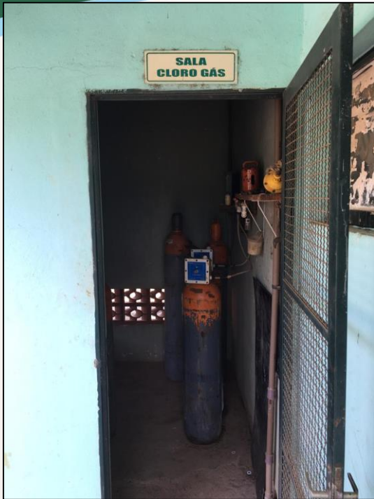
Figura 32 – Local de armazenamento de cloro gás
