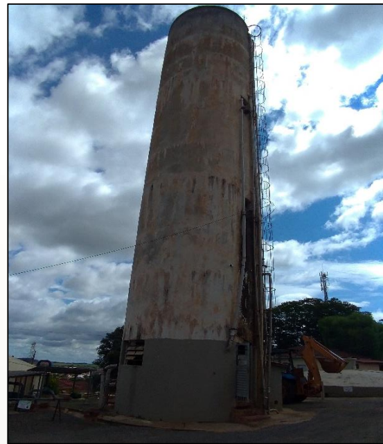
Figura 39 - REL01 (localizado no Centro de Reservação).
