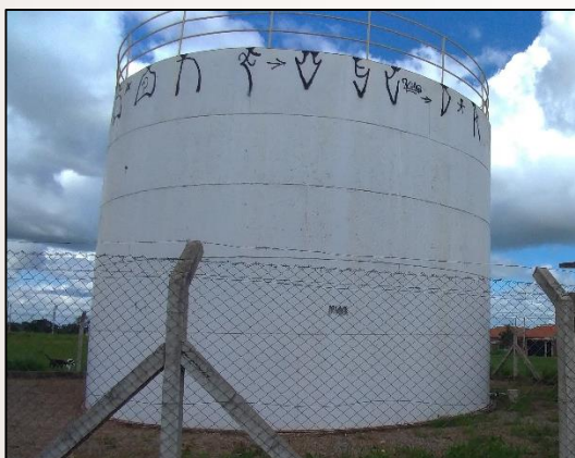
Figura 42 - Reservatório de Distribuição – COHAB 6
