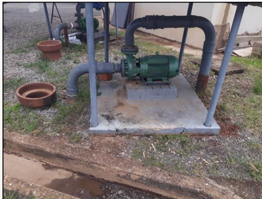
Figura 51 – Bomba localizada no centro de reservação
