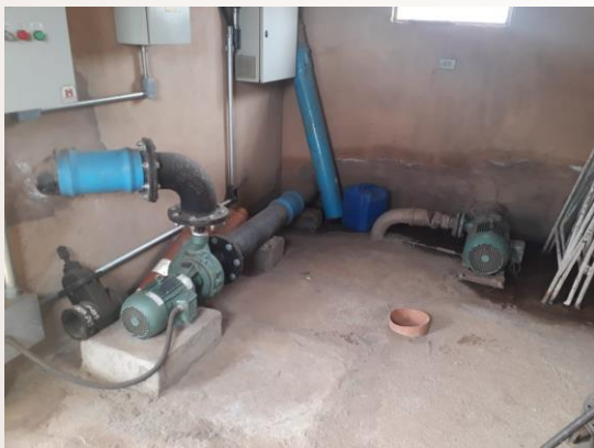
Figura 58 – Boosters que abastecem a região do Jd. Paulista e o reservatório da COHAB 6.
