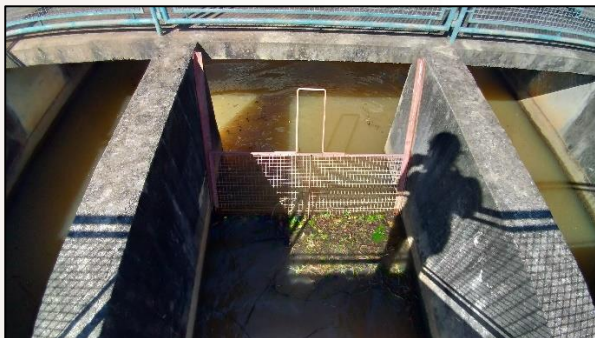
Figura 21 – Sistema de Gradeamento
