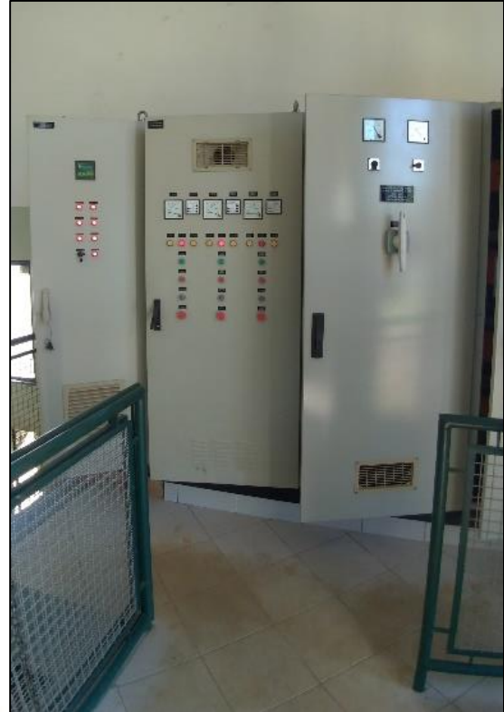
Figura 47 – Painéis elétricos das bombas
