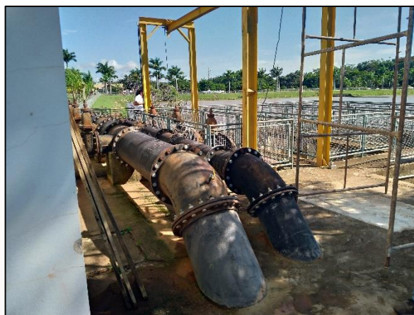
Figura 20 – A esquerda tubulação de adução tratada e a direita de água bruta
