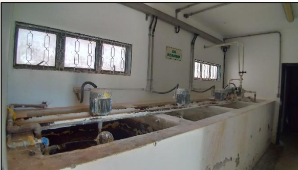
Figura 30 – Tanques de Cal Hidratada
