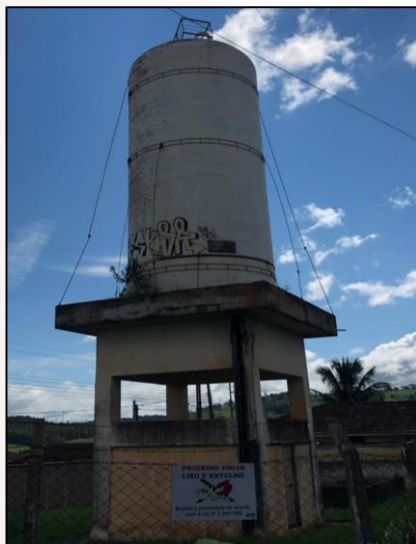
Figura 40 - Reservatório de Distribuição - Vila Polar.
