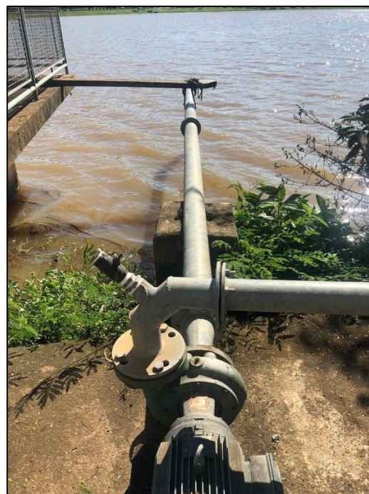
Figura 22 – Tubulação pra captação de água bruta para abastecimento de caminhões pipa
