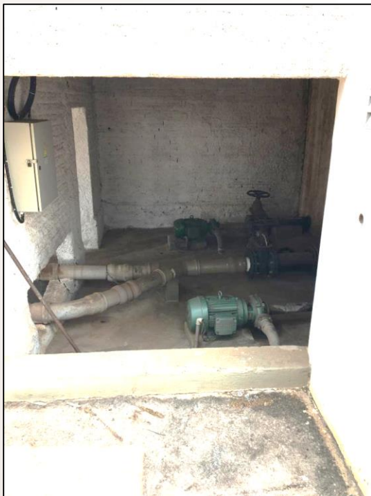
Figura 54 – Bombas localizadas no centro de reservação
