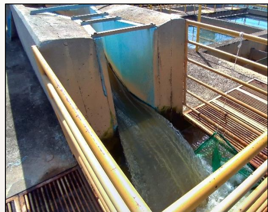
Figura 27 – Calha Parshall direcionando a água para os floculadores
