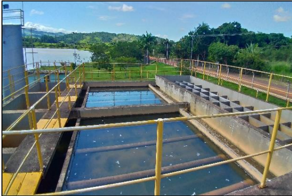
Figura 28 – Vista de cima de uma das células de tratamento da ETA.
