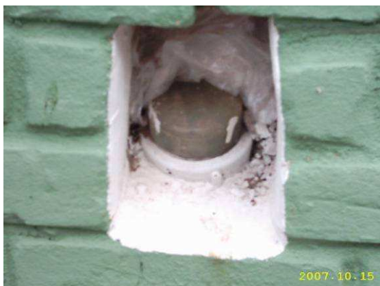
Figura 84. Hidrômetro sem condições de leitura.
