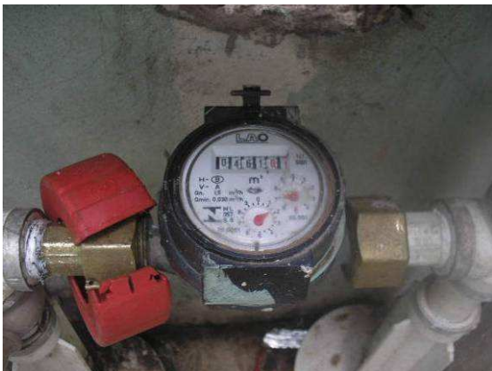
Figura 70. Hidrômetro com lacre violado.
