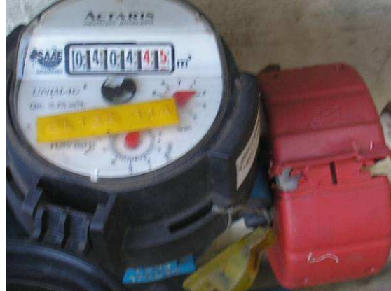
Figura 69. Hidrômetro com lacre violado.
