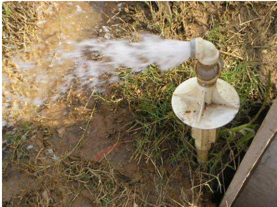
Figura 62. Cavalete sem hidrômetro.
