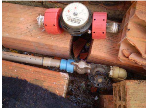
Figura 63. Cavalete sem Hidrômetro.
