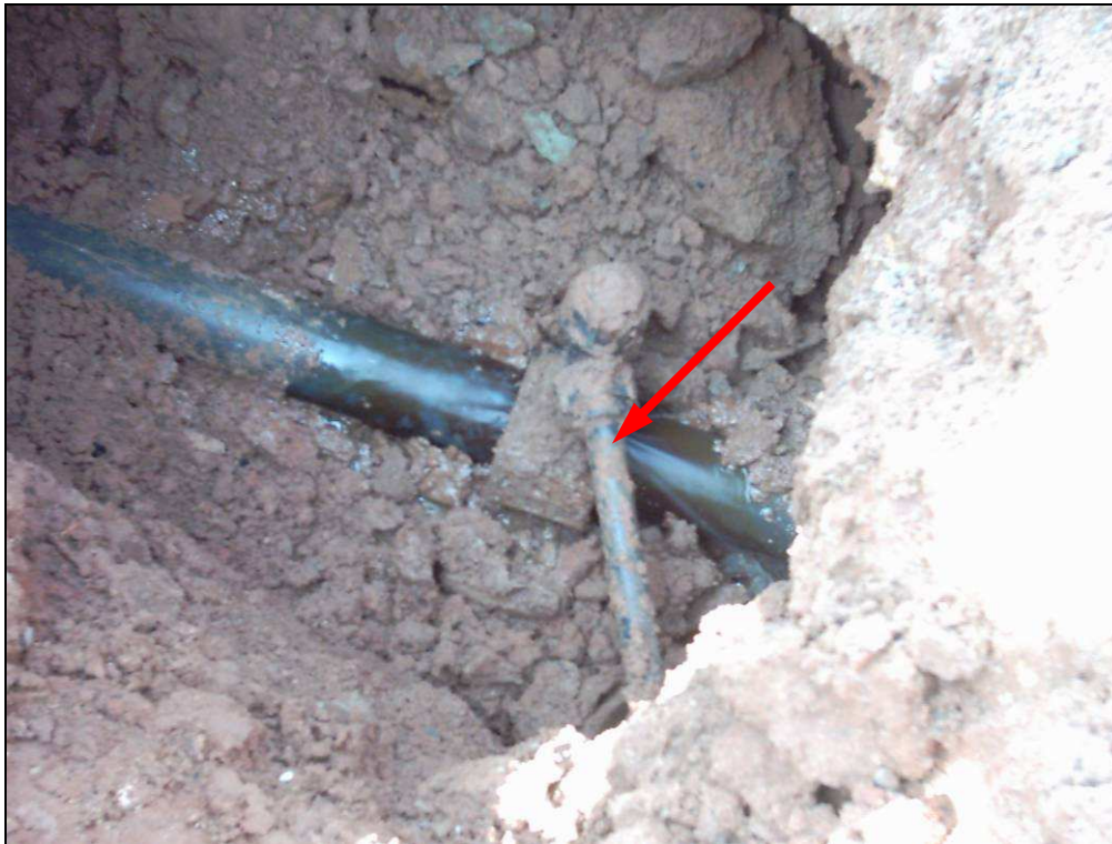
Figura 61. Localização do vazamento no ferrule.
