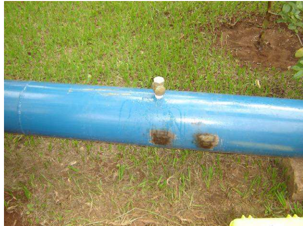
Figura 33. Estação Pitométrica (EP) instalada em uma tubulação de água.
