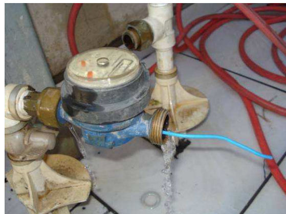
Figura 67. Hidrômetro com arame.
