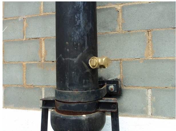
Figura 44. Estação Pitométrica 04 situada no recalque do Jardim Pacaembu (Central) para o Jardim Paulista.
