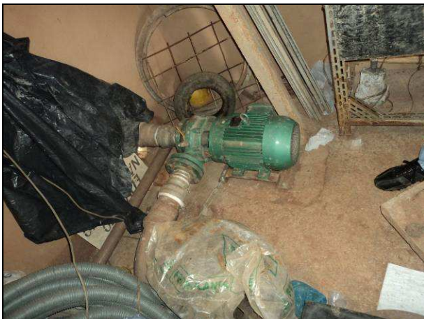
Figura 18: Vista geral do conjunto motor bomba do Jd. Paulista.
