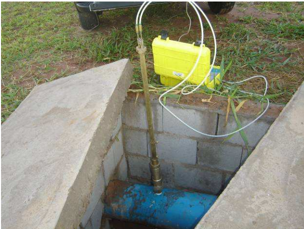
Figura 38. Tubo Pitot inserido em uma tubulação e conectado a um equipamento que contém um sensor de diferencial de pressão.
