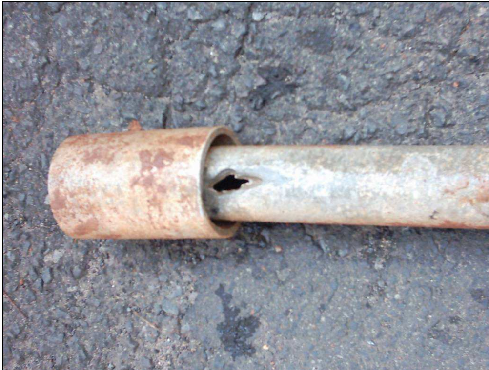
Figura 57. Furo na rede que causou o vazamento.
