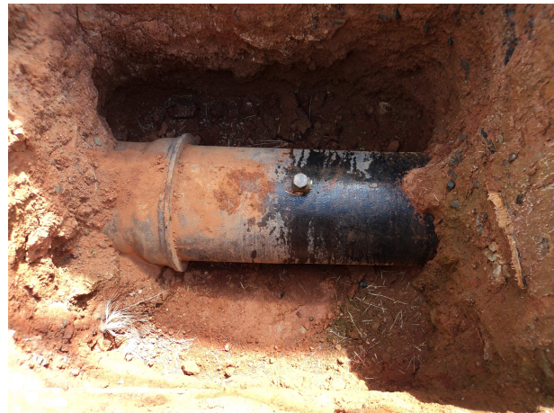
Figura 42. Estação Pitométrica 02 instalada no recalque de água tratada da ETA para o Reservatório do Jardim Pacaembu (Central).
