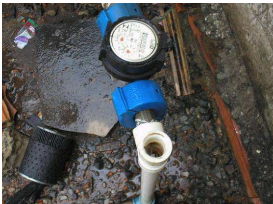
Figura 66. Hidrômetro com arame.
