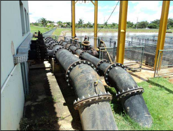
Figura 2: Vista geral da casa de bombas de água bruta e adutoras.
