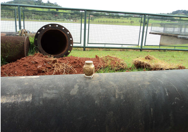
Figura 41. Estação Pitométrica 01 instalada na adutora de água bruta situada na entrada da ETA.
