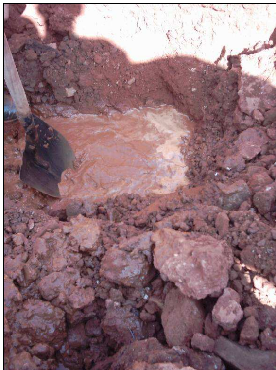
Figura 60. Localização do vazamento não visível.
