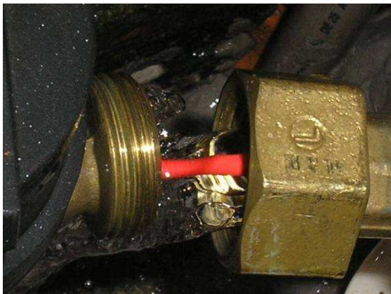
Figura 64. Hidrômetro com arame.
