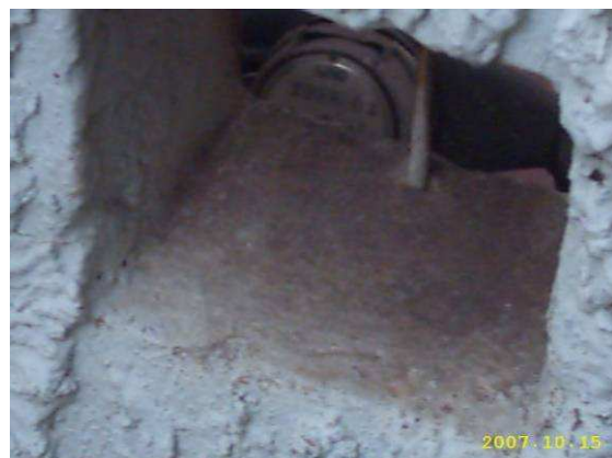
Figura 85. Hidrômetro sem condições de leitura.
