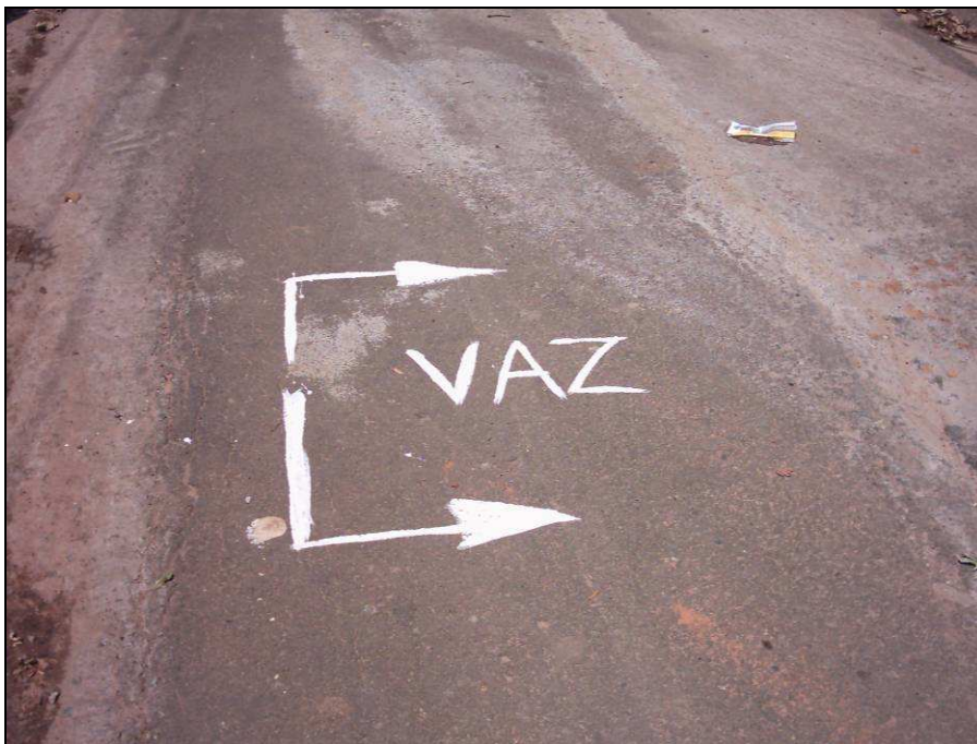
Figura 54. Demarcação com tinta branca no local onde foi detectado vazamento não visível.
