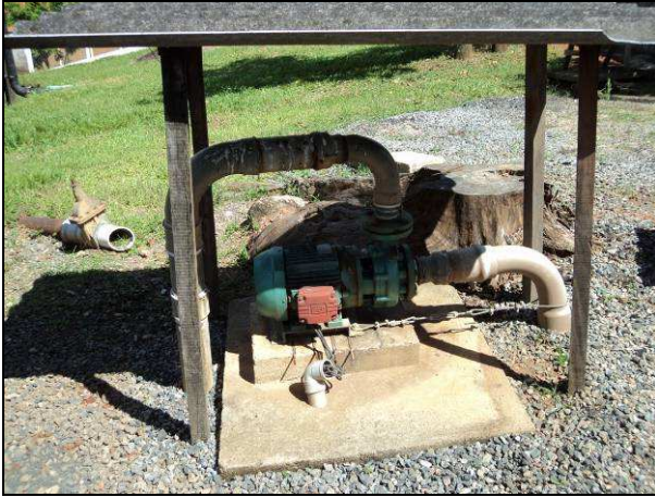
Figura 14: Vista do conjunto motor bomba com recalque para V. Santa Terezinha.
