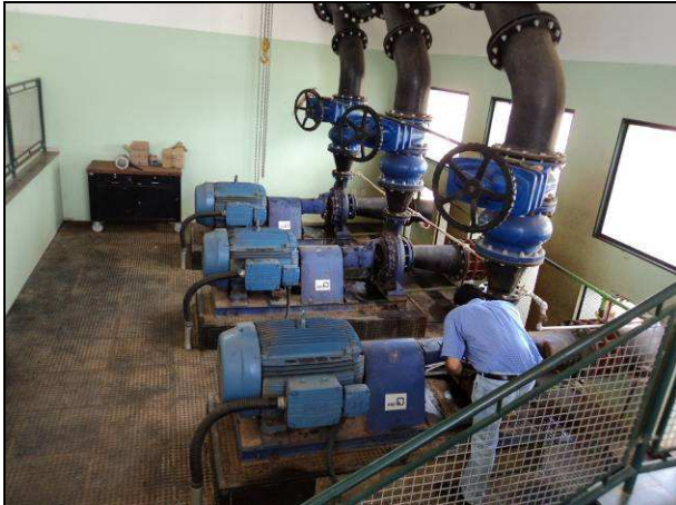
Figura 8: Vista do interior da casa de bombas com os conjuntos motor bomba.
