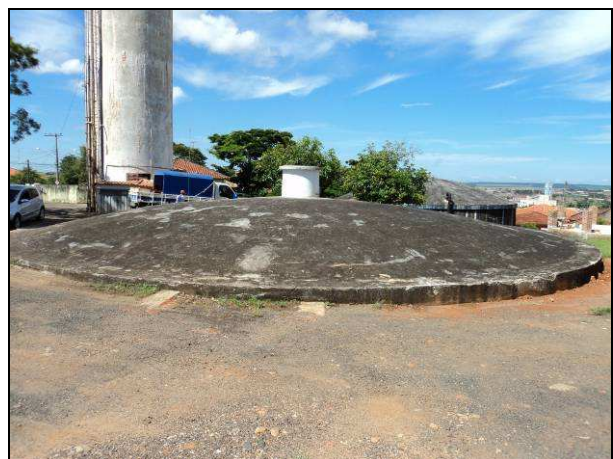
Figura 9: Vista geral dos reservatórios apoiados no Jd. Pacaembu.
