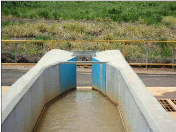
Figura 4: Vista da calha Parshall no Módulo nº 01 do tratamento.
