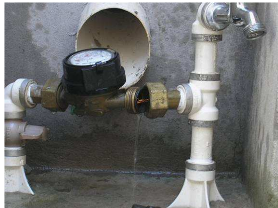
Figura 65. Hidrômetro com arame.
