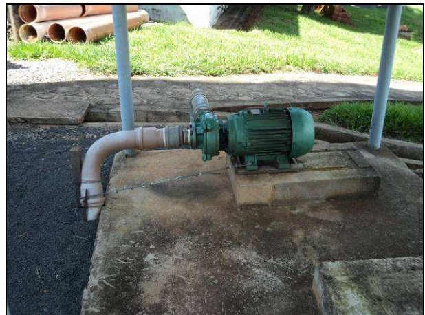
Figura 15: Vista do conjunto motor bomba com recalque para V. Polar de Fora.
