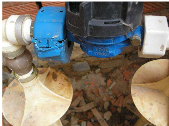
Figura 71. Hidrômetro com lacre violado.
