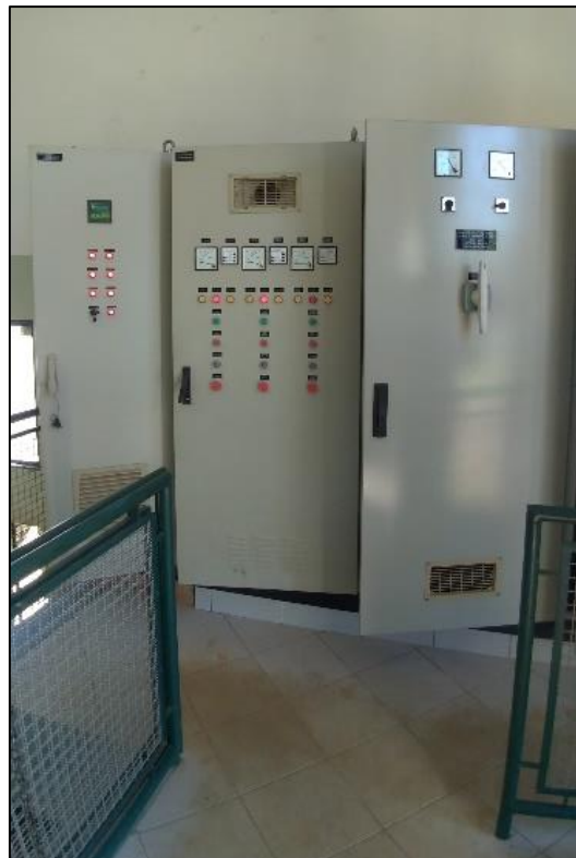
Figura 34 – Painéis elétricos das bombas
