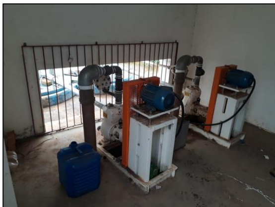
Figura 60 – Bombas da EEE Cardoso.
