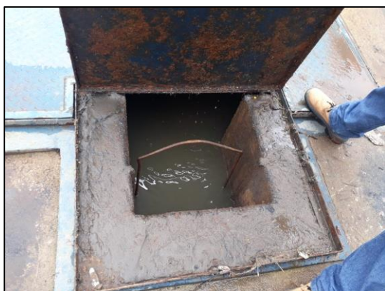
Figura 68 – Gradeamento da EEE Verona que encontrava-se sobrecarregado
