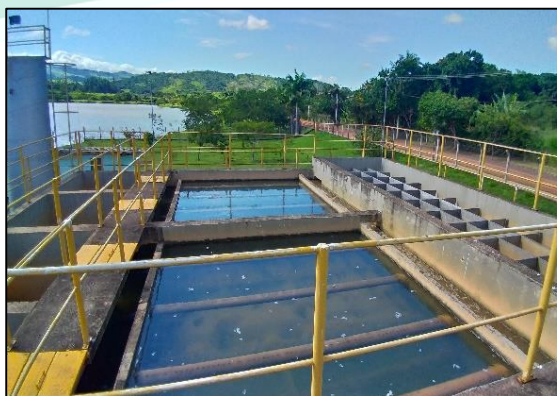
Figura 24 – Vista de cima de uma das células de tratamento da ETA.
