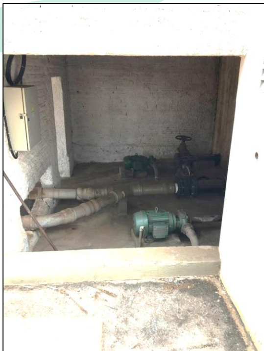
Figura 41 – Bombas localizadas no centro de reservação
