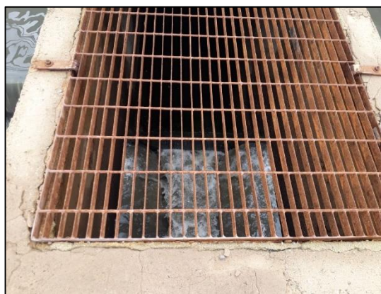
Figura 104 – Caixa de passagem para as lagoas
