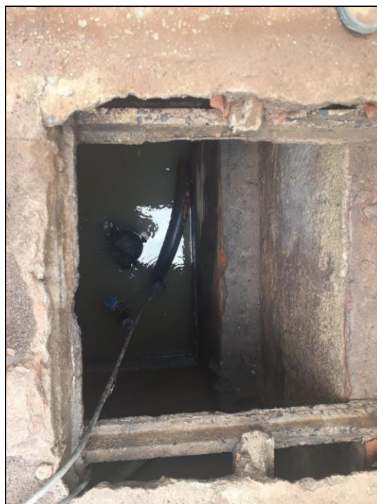
Figura 81 – Poço de sucção da EEE Santa Marta
