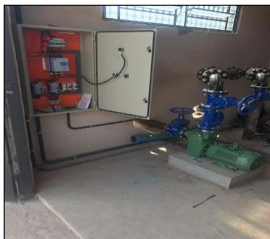
Figura 87 – Bombas e painel elétrico da EEE Vila Esperança Fonte: SAE, 2019.
