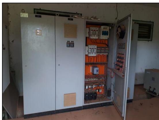
Figura 94 – Painéis elétricos da bomba da EEAT de esgoto da ETE.
