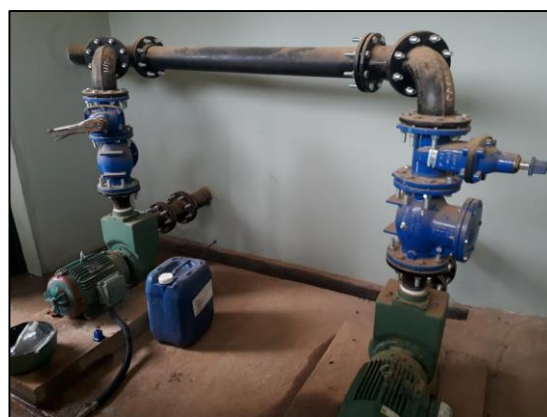
Figura 69 – Vista das bombas da EEE Perobeira
