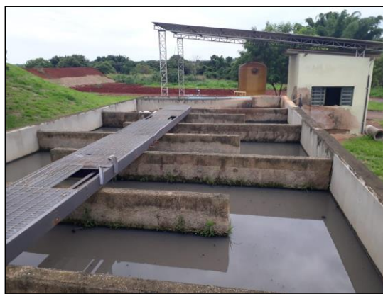
Figura 114 – Tanque de contato.
