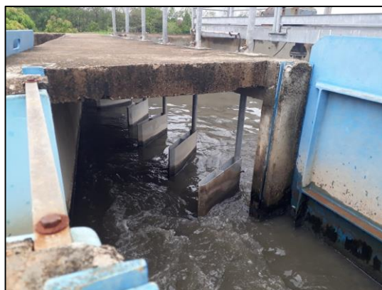
Figura 100 – Adensadores de resíduos sobrenadante.
