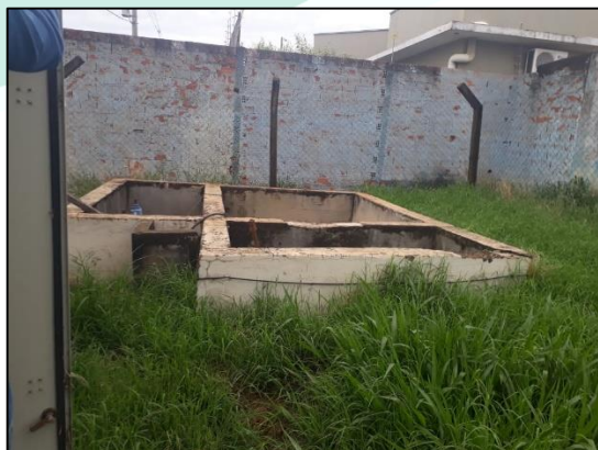
Figura 74 – Vista do interior da EEE Distrito Industrial
