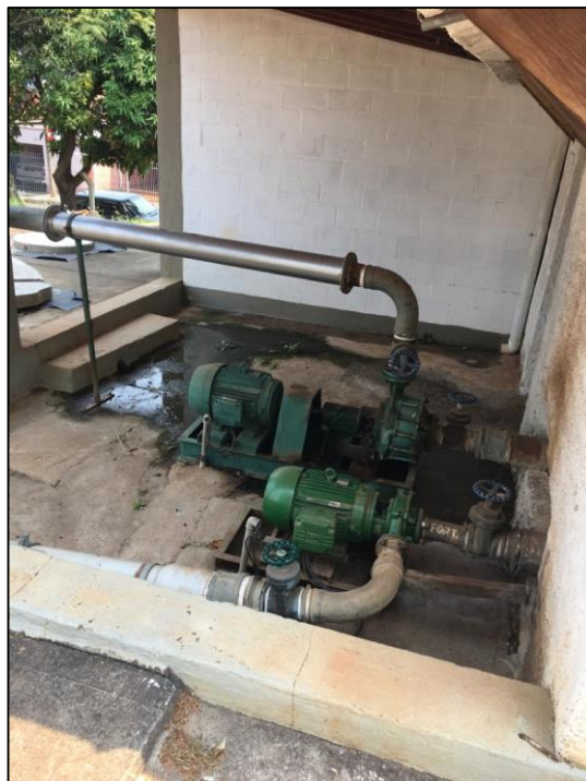
Figura 42 – Bombas localizadas no centro de reservação
