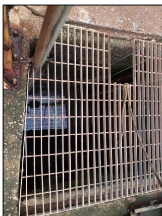
Figura 91 – Caixa de passagem com gradeamento mecanizado.
