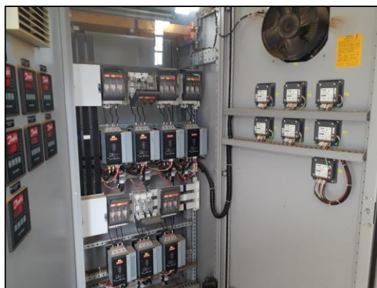
Figura 108 – Painel elétrico dos aeradores.
