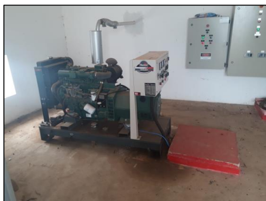
Figura 83 – Gerador da EEE Canaã
