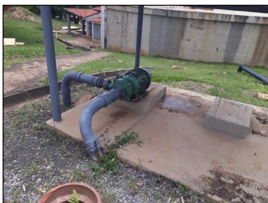
Figura 37 – Bomba localizada no centro de reservação
