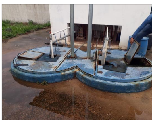
Figura 61 – Poços de sucção de esgoto da EEE Cardoso.
