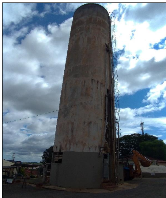
Figura 51 – Reservatório elevado localizado no Centro de Reservação.
