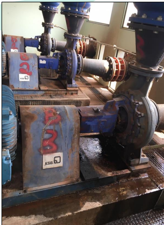
Figura 33 – Vazamentos nas bombas de captação
