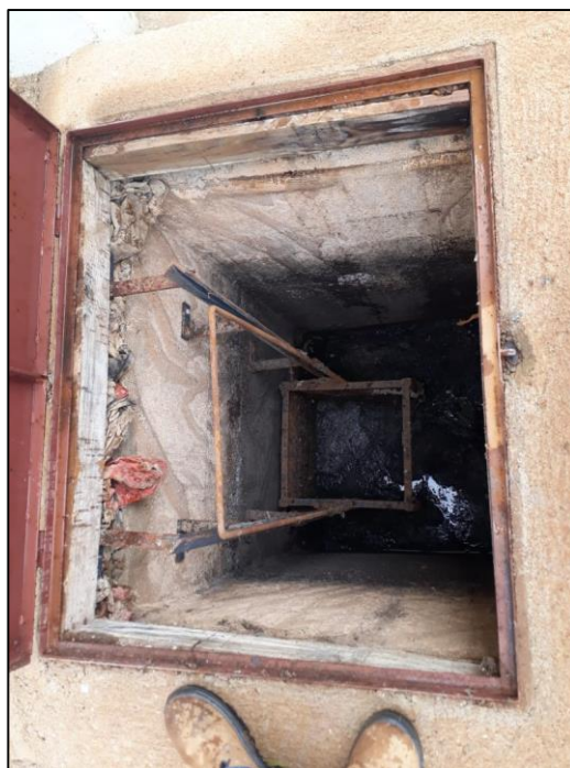
Figura 71 – Gradeamento da EEE Perobeira
