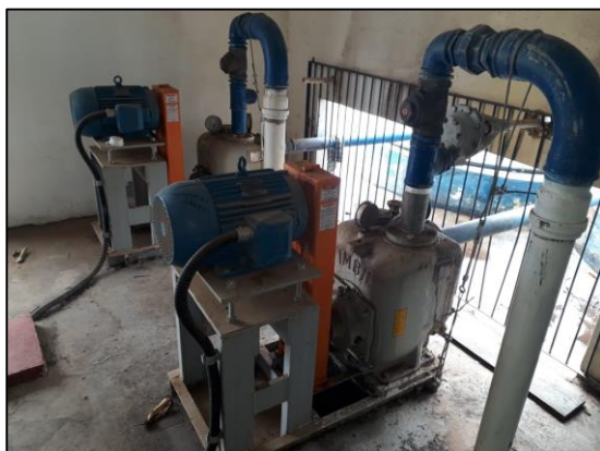
Figura 66 – Bombas da EEE Verona
