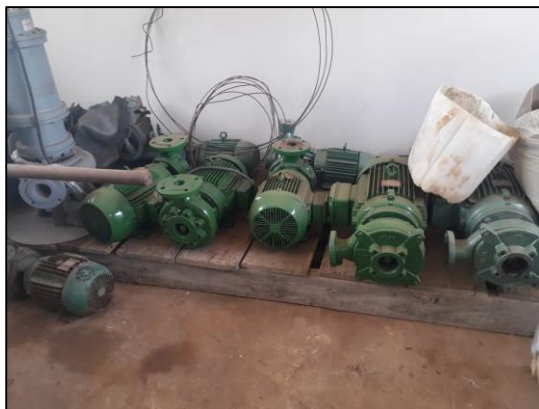
Figura 39 – Local de armazenamento das bombas reservas
