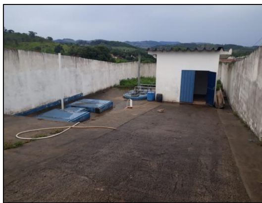
Figura 59 – Vista do interior da EEE Cardoso.
