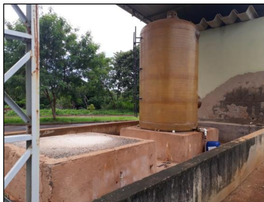
Figura 112 – Reservatório de hipoclorito de sódio com tanque de contenção.
