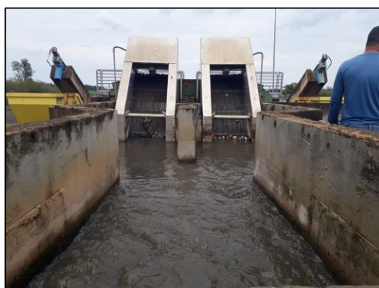
Figura 96 – Caixa de areia e gradeamento de resíduos finos mecanizado
