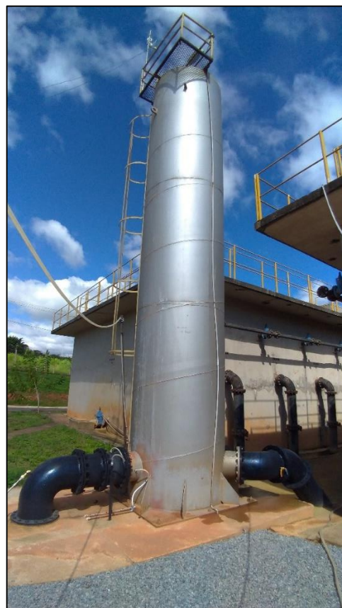
Figura 21 - Torre de mistura de produtos químicos com a água bruta
