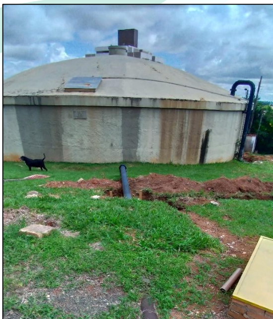
Figura 50- Reservatório apoiado localizado no Centro de Reservação.
