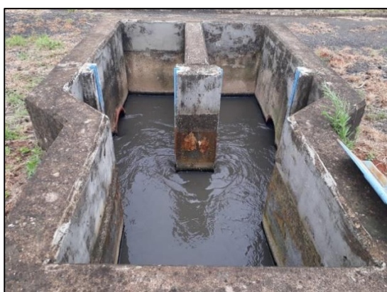
Figura 105 – Caixa divisória de esgoto para as lagoas aeradas.
