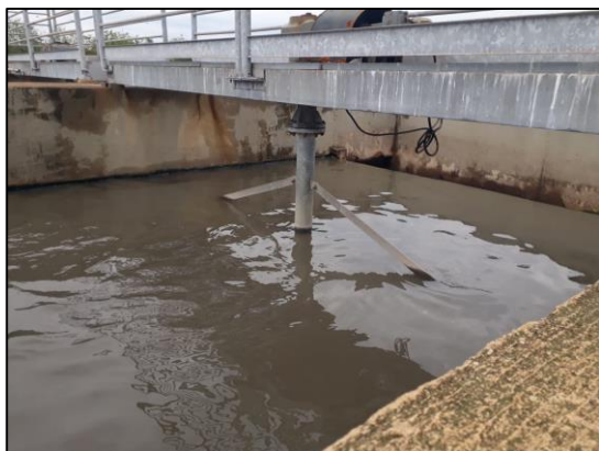
Figura 101 – Adensador de lodo.
