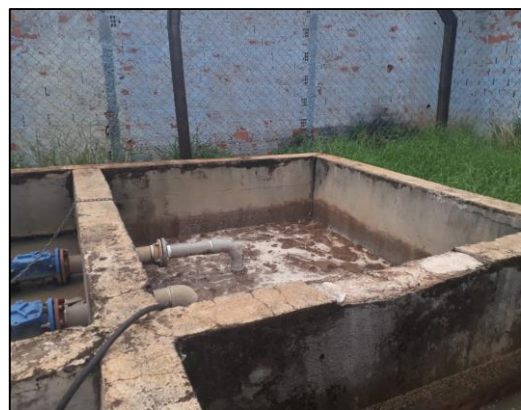
Figura 75 – Poço de sucção da EEE Distrito Industrial
