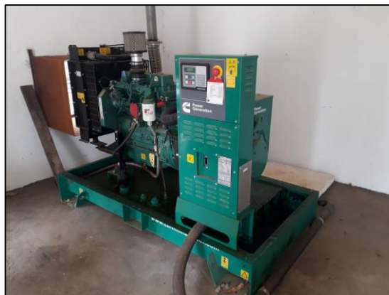
Figura 65 – Gerador da EEE Verona
