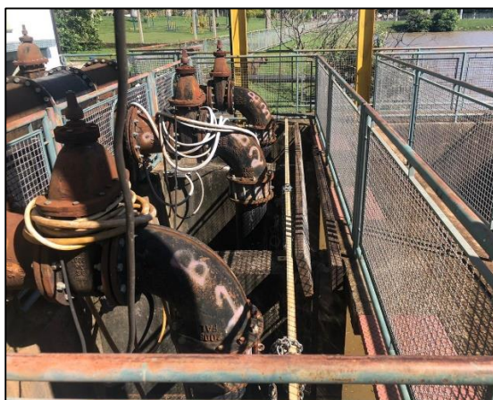
Figura 15 – Tubulação de adução de água bruta
