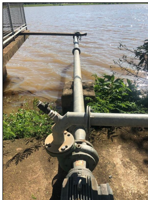
Figura 18 – Tubulação pra captação de água bruta para abastecimento de caminhões pipa
