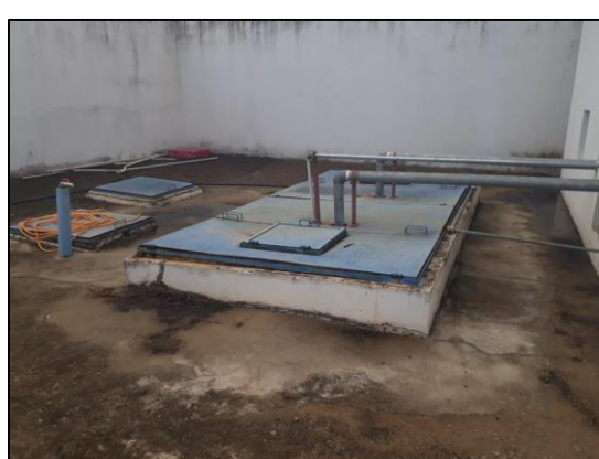
Figura 85 – Poços de sucção de esgoto da EEE Canaã
