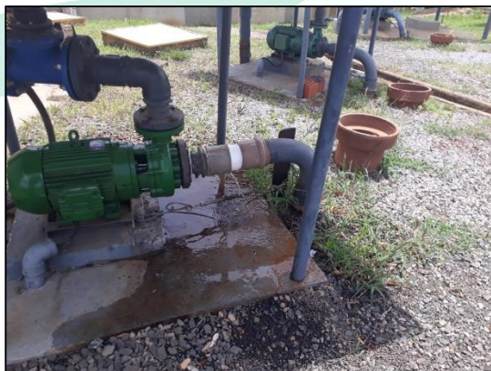
Figura 35 – Bomba localizada no centro de reservação.
