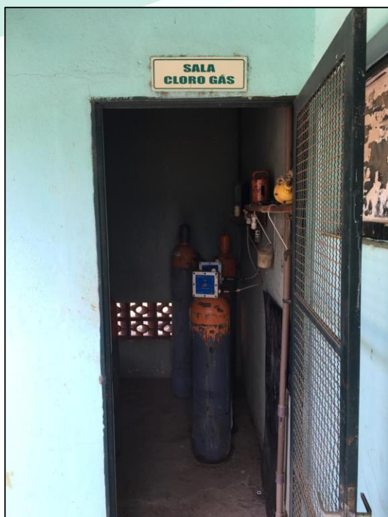
Figura 28 – Local de armazenamento de cloro gás
