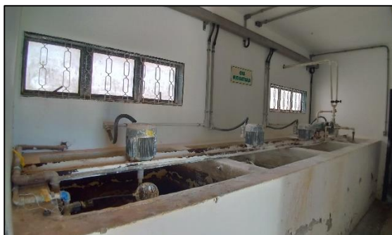
Figura 26 – Tanques de Cal Hidratada
