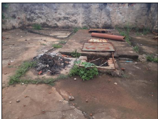
Figura 80- Vista do interior da EEE Santa Marta
