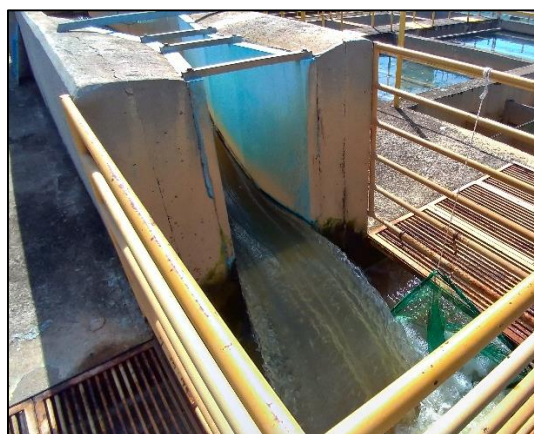
Figura 23 – Calha Parshall direcionando a água para os flocladores
