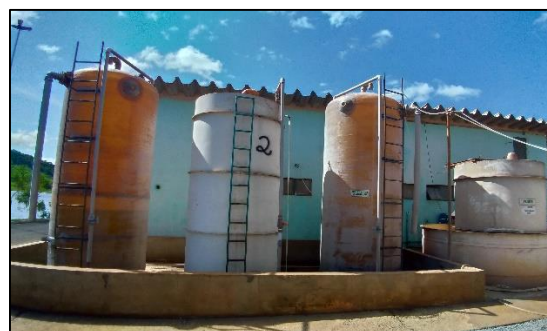
Figura 27 – Três tanques de armazenamento de sulfato de alumínio e tanque de armazenamento de ácido fluorsilícico da esquerda para a direita, respectivamente.
