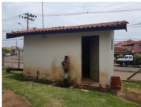
Figura 44 – Casa das bombas
