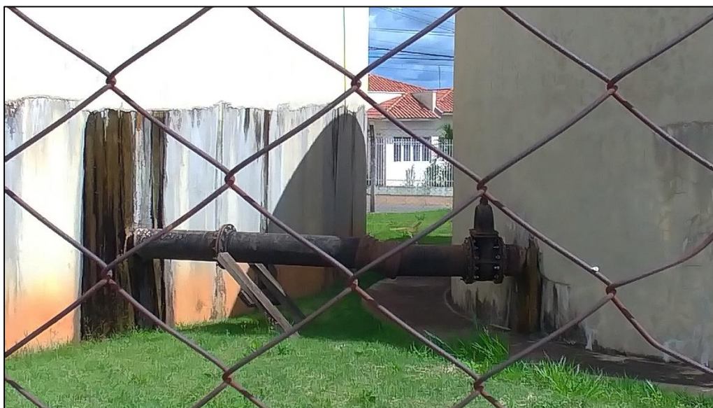
Figura 56 - Reservatórios Jardim Paulista interligados, com infiltrações.
