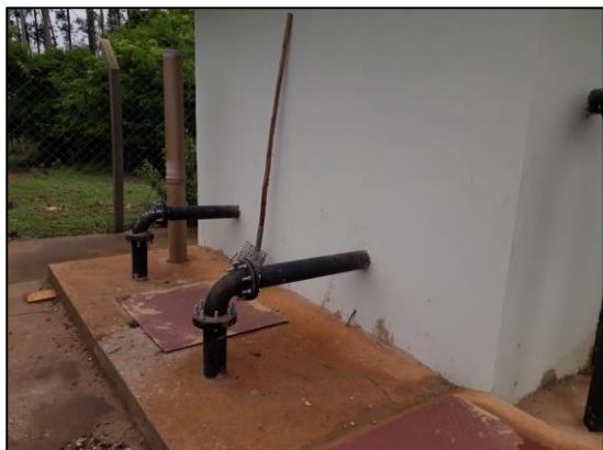
Figura 70 – Poço único de sucção da EEE Perobeira
