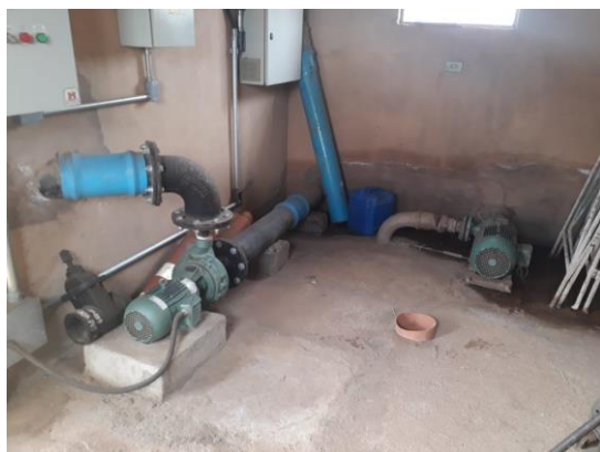
Figura 45 – Boosters que abastecem a região do Jd. Paulista e o reservatório da COHAB 6.
