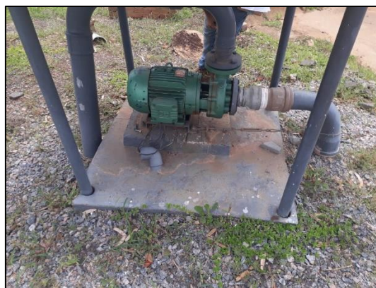
Figura 36 – Bomba localizada no centro de reservação
