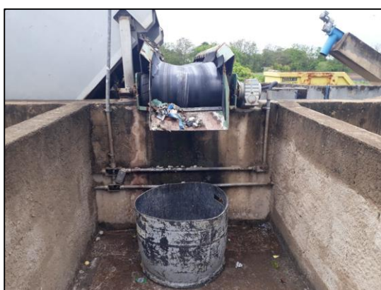
Figura 97 – Esteira de coleta de resíduos retidos no gradeamento
