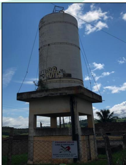
Figura 52 - Reservatório de Distribuição - Vila Polar.
