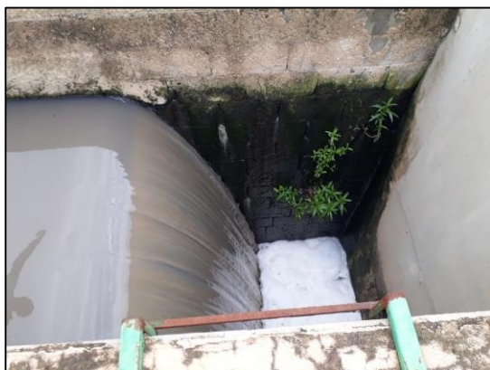
Figura 115 – Degrau de aeração no final do tanque de contato.
