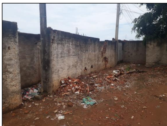
Figura 78 – Vista da parte externa da EEE Santa Marta.
