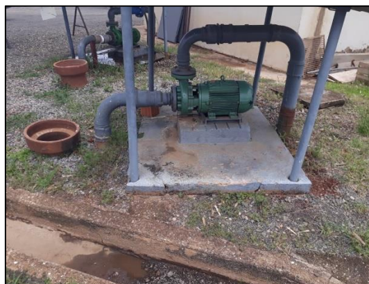
Figura 38 – Bomba localizada no centro de reservação
