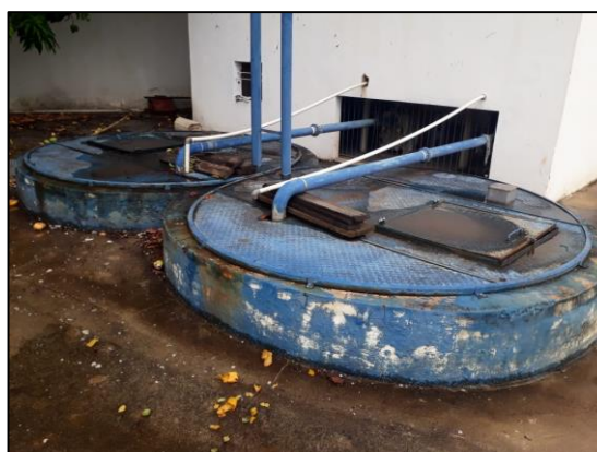
Figura 67 – Poços de sucção de esgoto da EEE Verona
