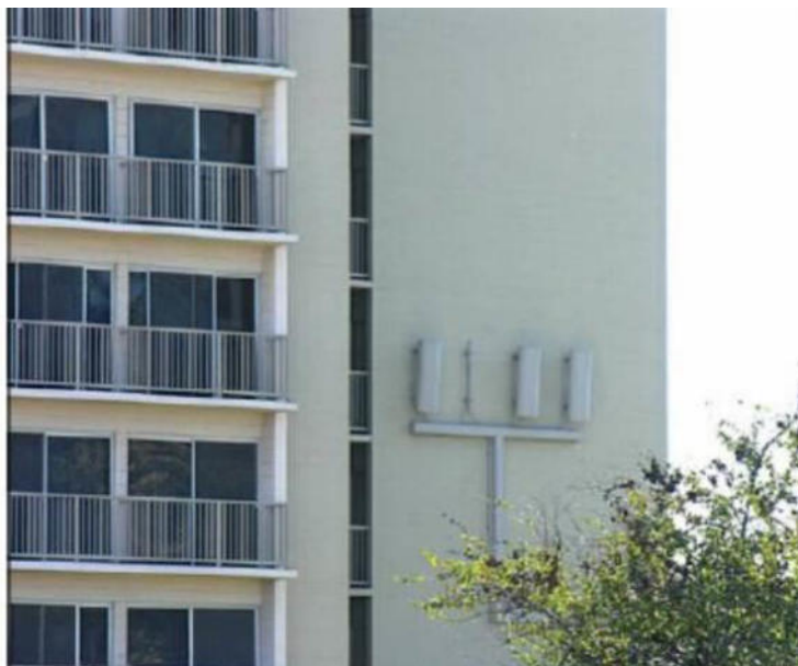
Exemplo de Estação Rádio Base do tipo ROOF TOP
